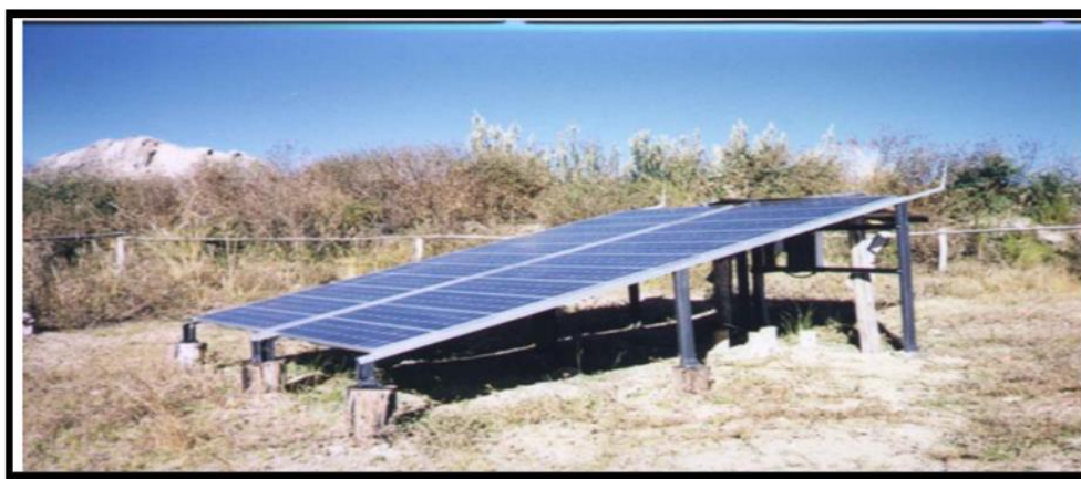
Panel solar del Hotel Isla Suasi
