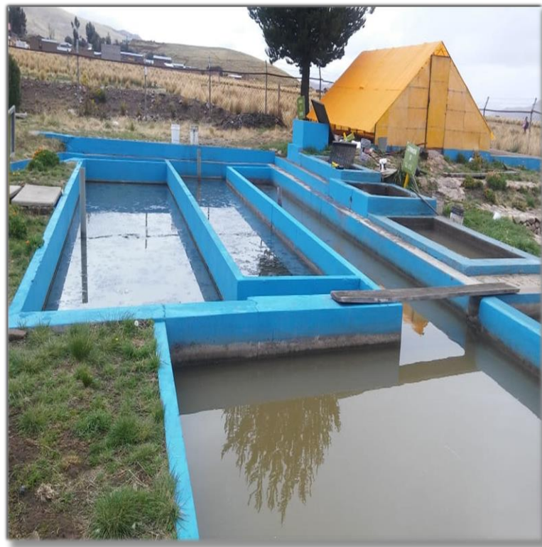
Figura 9. Filtros de arena y grava Fuente: Elaborado por el equipo de trabajo
