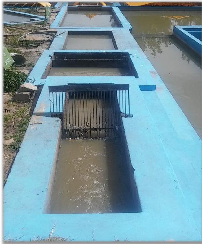
Figura 5. Cámara de rejas Fuente: Elaborado por el equipo de trabajo
