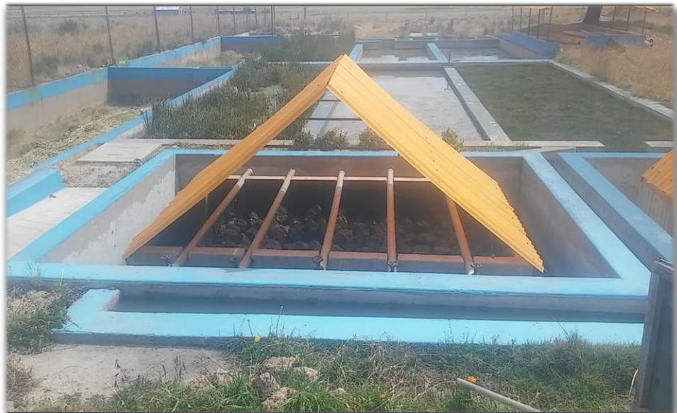
Figura 10. Filtro percolador Fuente: Elaborado por el equipo de trabajo
