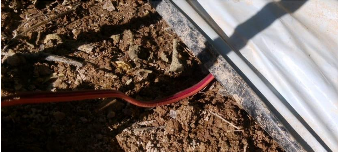
Figura N° 23: Cables que conectan a los sensores ubicados debajo de la manta protectora.
