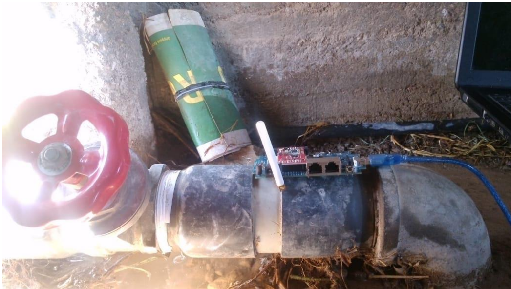
Figura N° 27: Servidor ubicado junto a la válvula de agua.
