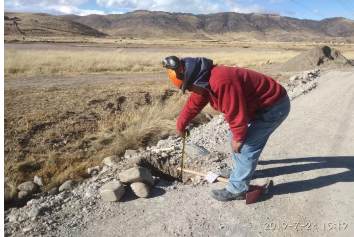
Figura 8. la fotografía muestra movimientos de masa en plataforma.
