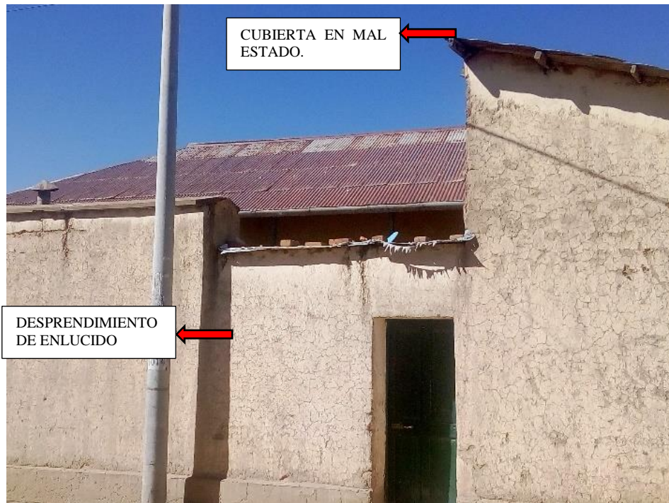
Figura 108: Fotografía de lesiones en fachada oeste.
