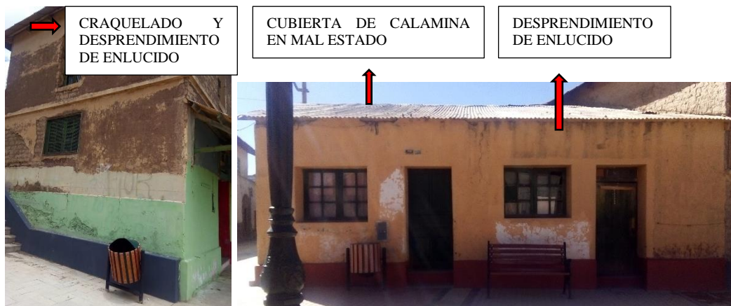
Figura 112: Patologías de fachada sur de edificio de estación.
