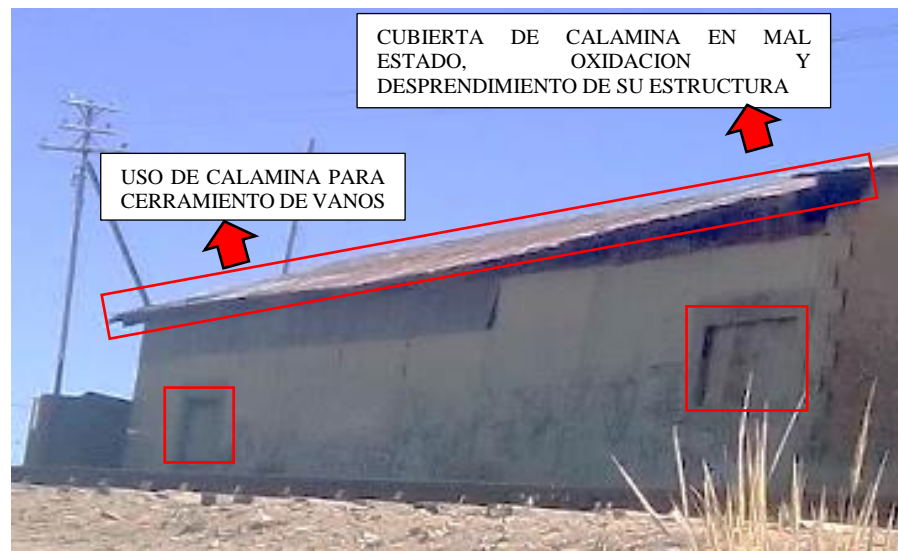
Figura 89: Fotografía donde se muestra el uso de calamina en zonas no adecuadas.
