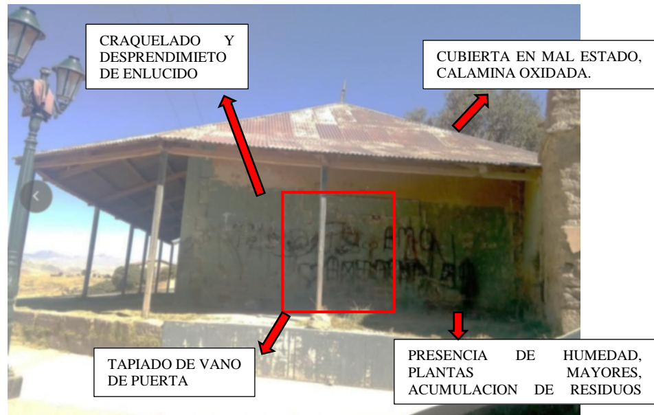
Figura 93: Fotografía de la fachada norte- patologías.
