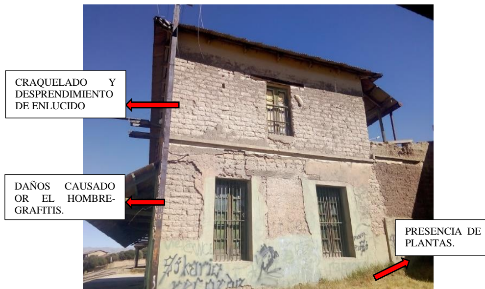
Figura 110: Patologías en fachada norte del edificio estación.
