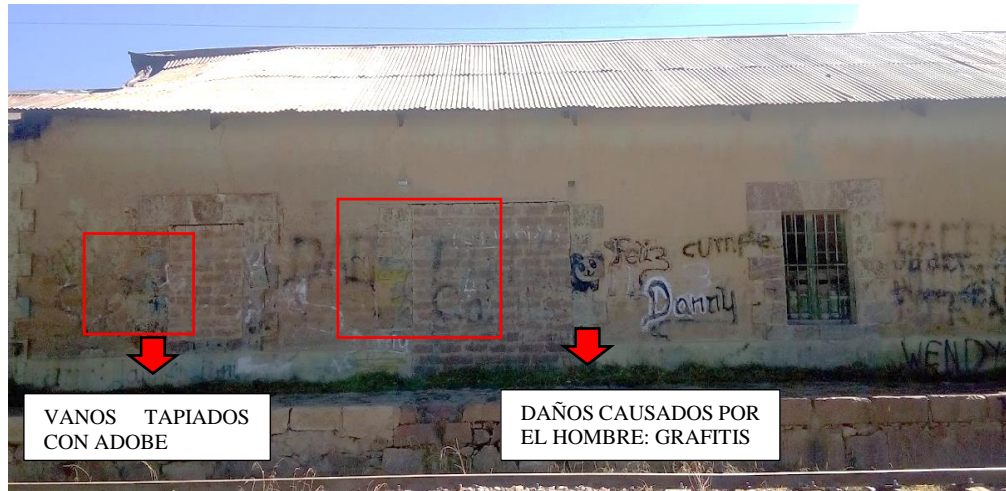
Figura 88: Fotografía de vanos tapiados.
