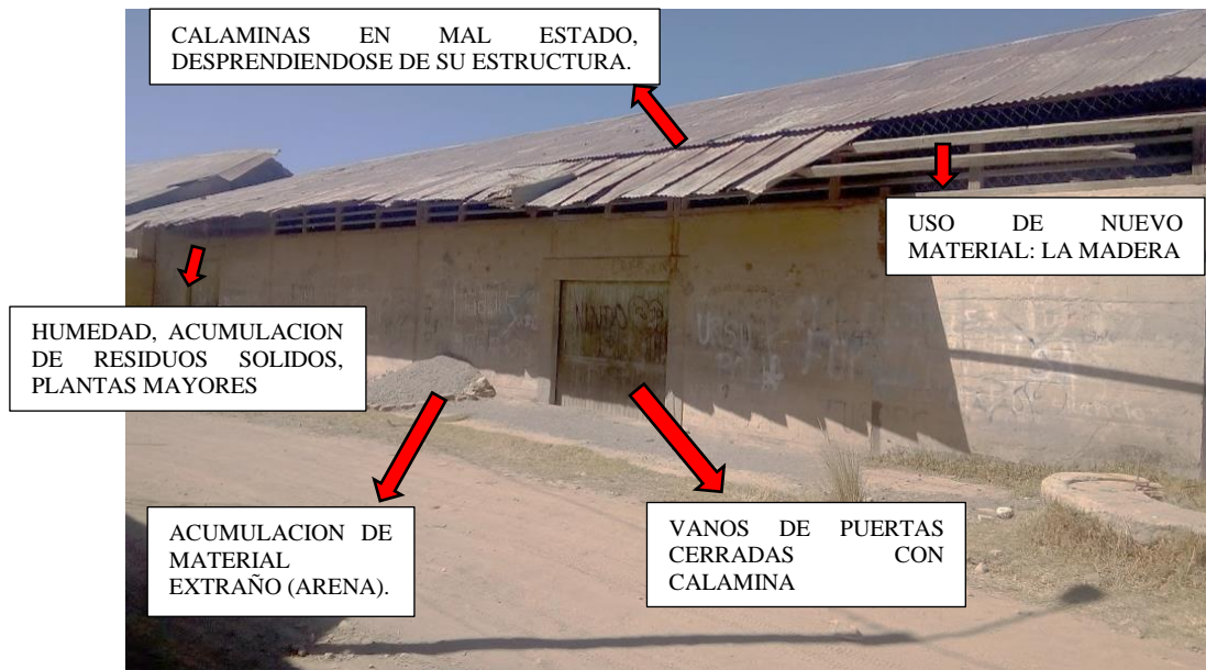
Figura 91: Fotografía de fachada oeste- daños causados en la infraestructura.
