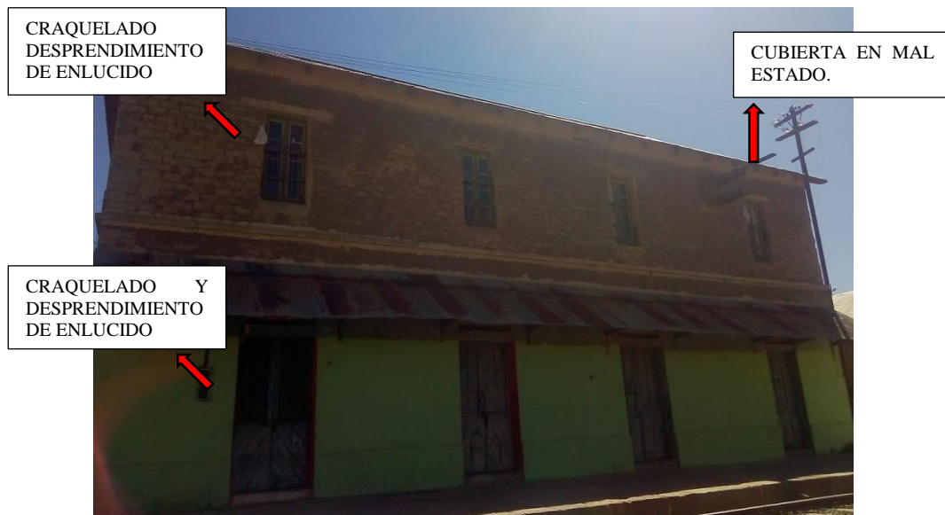
Figura 106: Lesiones en fachada este del edificio de estación.
