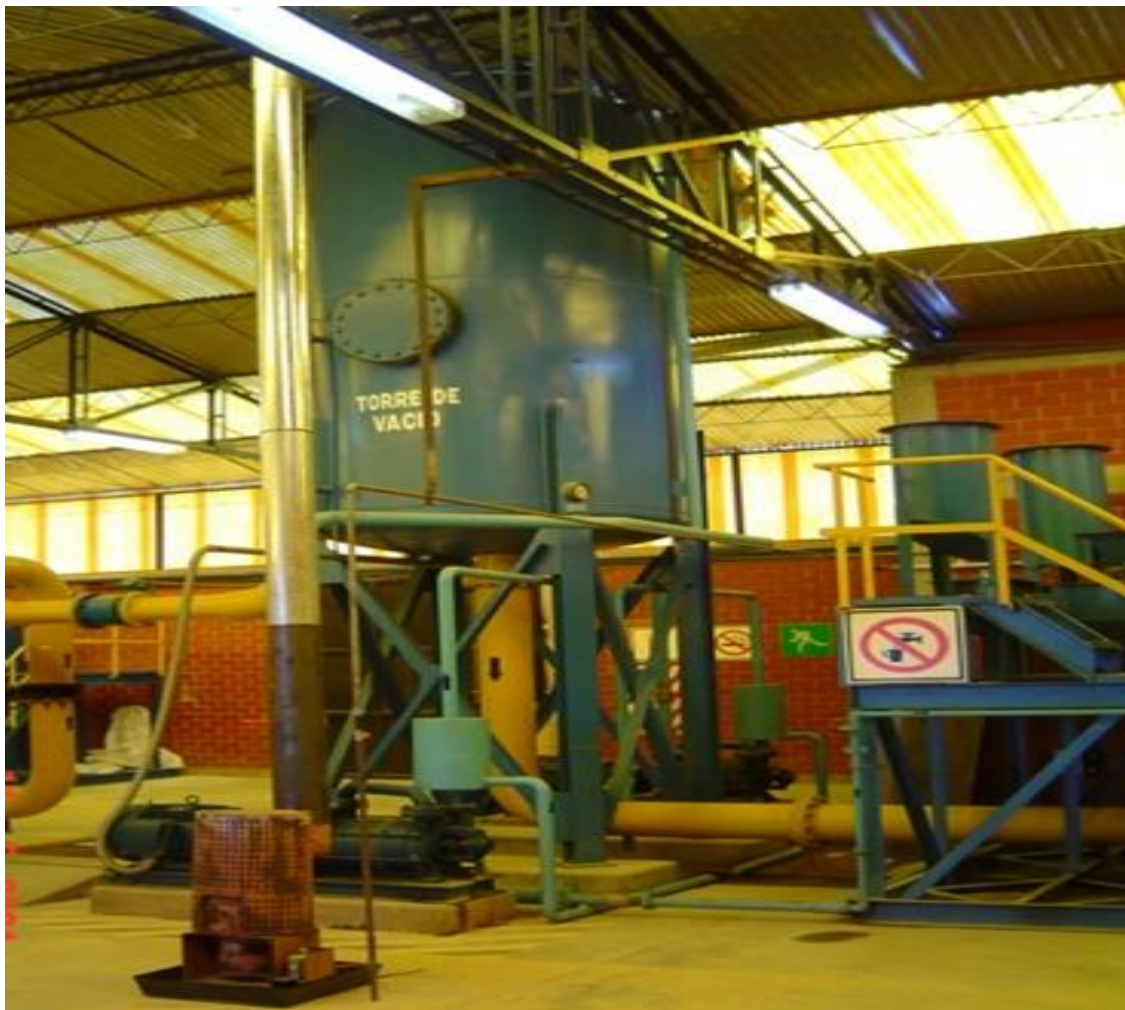
Figura 51. Torre de vacío
