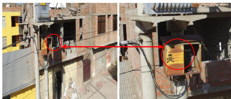
Figura N° 4.12: Tablero de distribución con oxido
