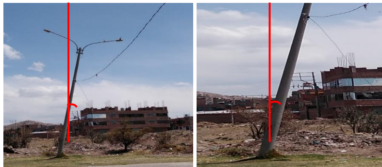
Figura N° 4.20: Poste de c.a.c. inclinado
