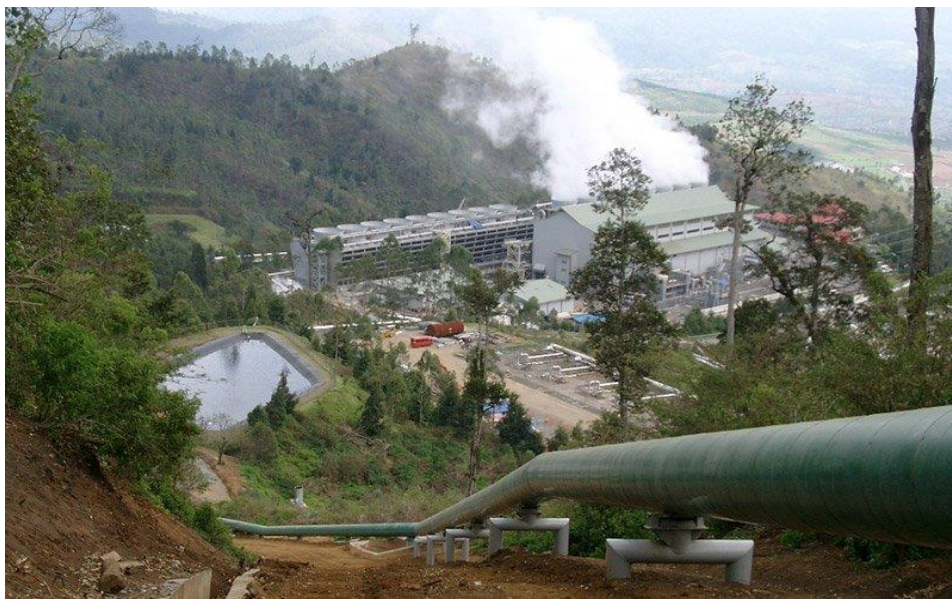
Figura N° 18: Complejo Geotérmico Darajat. 259 MW. Indonesia
