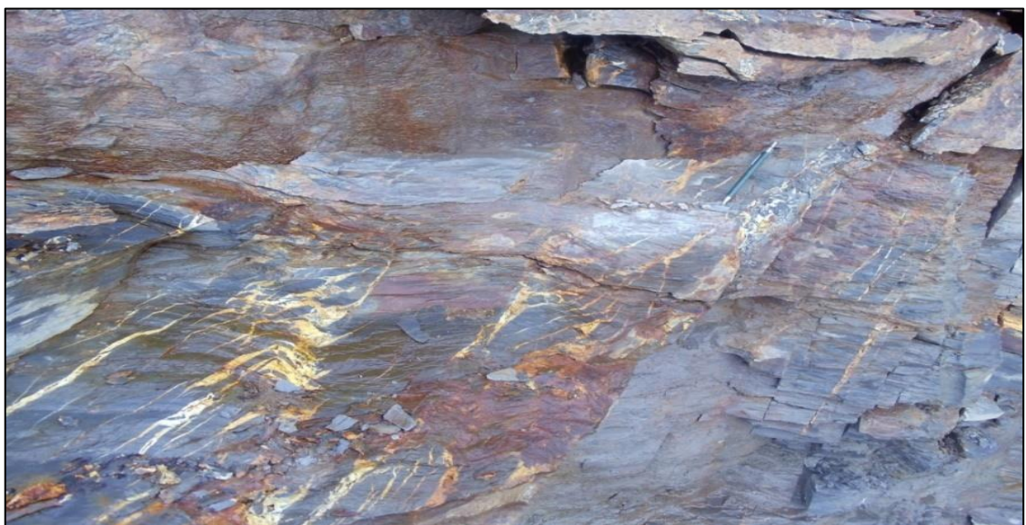
Figura 17. Brechamiento con grietas tensionales rellenas de cuarzo lechoso metamórfico en pizarra.
