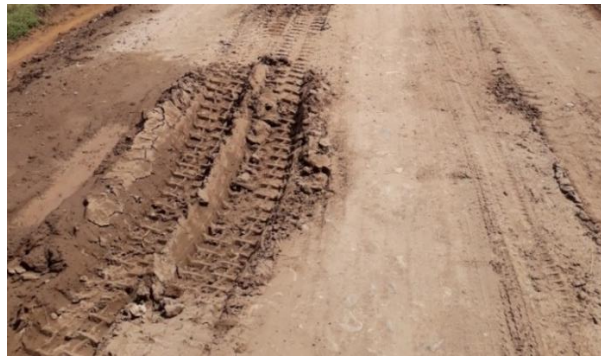
Figura 13: Antecedente de existencia de vehículos de alto tonelaje
