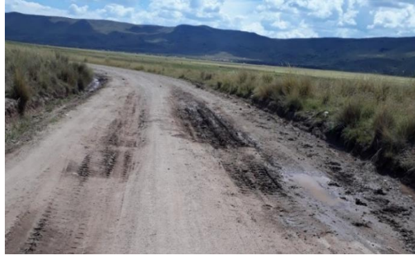
Figura 12: Presencia de falla por acolchonamiento
