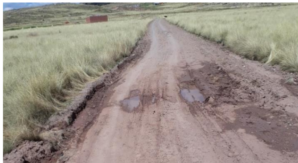
Figura 10: Falla por deficiencia en la capacidad de soporte
