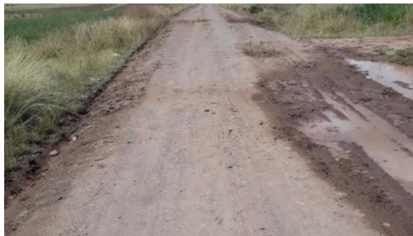
Figura 11: Erosión de la vía con la presencia de lluvias
