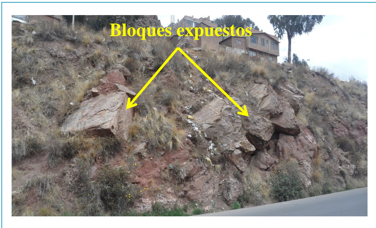
FIGURA N°7: Vista detallada de los bloques suspendidos, que pueden ceder por efectos de la gravedad, lluvias o sismo. AV. Circunvalación Norte.
