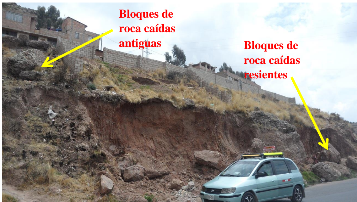
FIGURA N°6: Obsérvese bloques de roca de caídas antiguas y caídas resientes parte de la AV. Circunvalación Norte.
