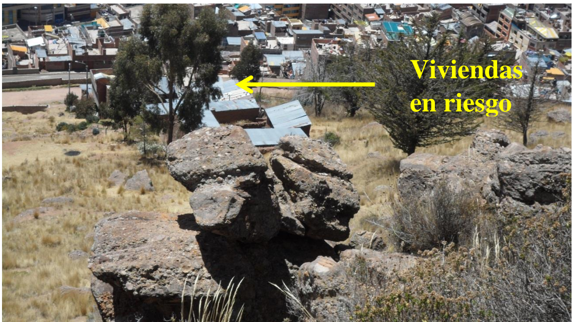
FIGURA N°12: Bloques de rocas expuestas a caídas que afectaría a las viviendas.
