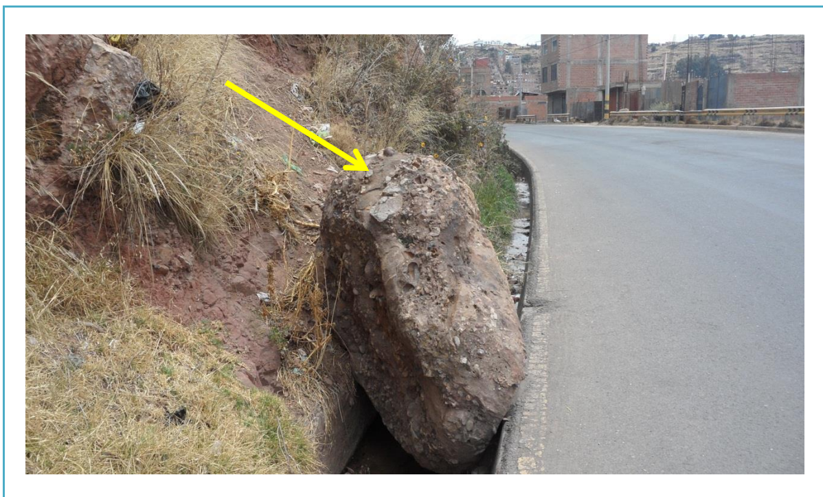
FIGURA N°8: Obsérvese los bloques producto de una caída de rocas resientes. AV. Circunvalación Norte.
