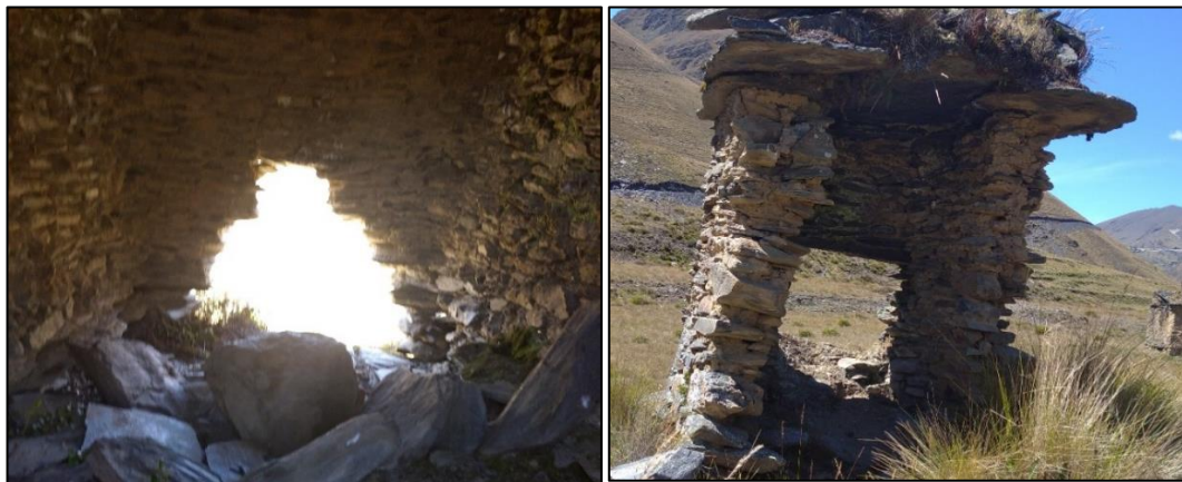
Figura 21. Deterioro de las Chullpas Fuente: la investigadora.
