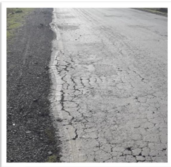
Foto 14: progresiva 1388+400 al 1389+800, tramo de vía en malas condiciones, presenta ahuellamientos, corrugaciones, fisuras de piel de cocodrilos, fisuras de borde y otras.
