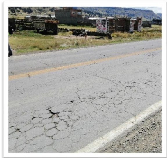
Foto 13: progresiva 1387+000 al 1387+550, pavimento asfáltico con deformaciones, presentan fisuras de piel de cocodrilo y fisuras longitudinales.
