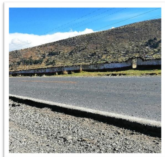
Foto 18: progresiva 1389+800 al 1390+00, borde de calzada afecta por la socavación del terreno de la berma en ambos sentidos.
