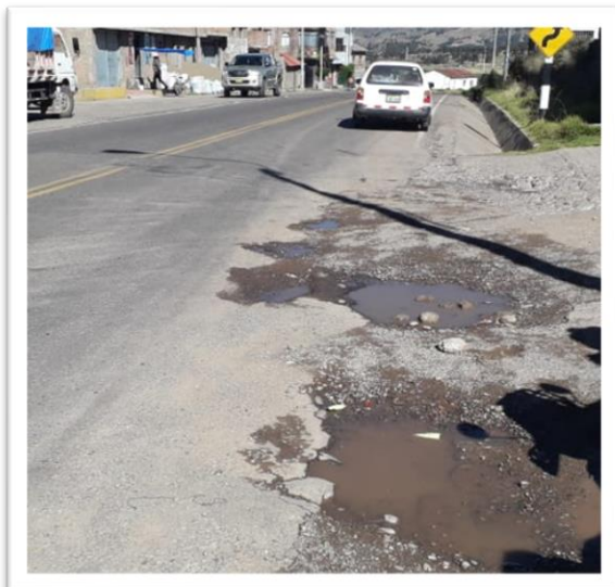
Foto 16: Progresiva 1377+510, Berma en mal estado presenta baches producto de la presencia de agua
