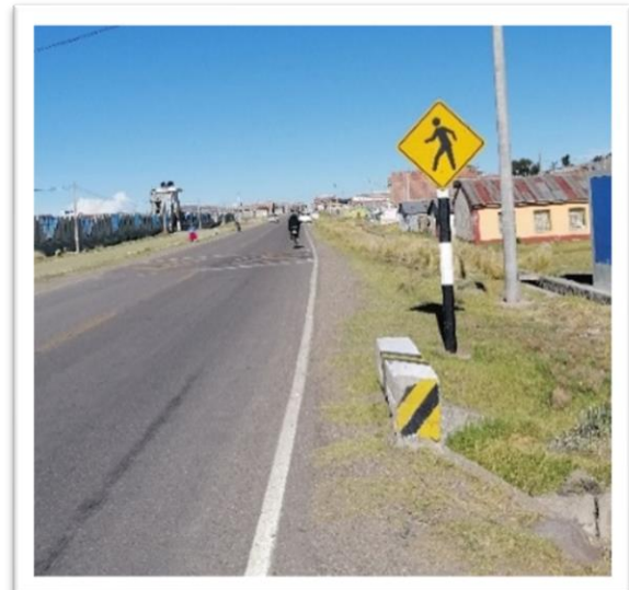
Foto 6: progresiva 1391+310 alcantarilla de concreto expuesto sobre el nivel de la calzada sin protección ante impactos
