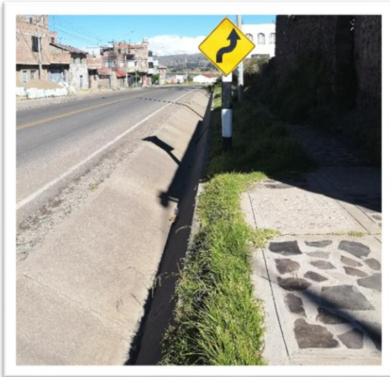
Foto 28: progresiva 1377+530, travesía urbana Chucuito, obras de arte de drenaje pluvial
