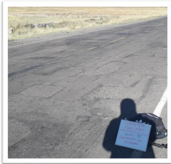
Foto 12: progresiva 1406+150 al 1407+150, pavimento asfáltico deteriorado, muchos tramos presentan iguales condiciones, algunos son tratados, pero igual están en pésimas condiciones.
