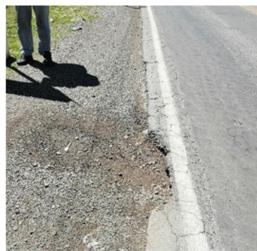
Foto 19: progresiva 1387+200, la berma presenta fallas como socavación del terreno, descalce de berma de 10 cm
