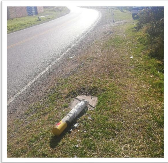
Foto 9: progresiva 1374+800, delineadores de curva extraídos, por impacto de vehículos, ya no cumplen con la función de guiar al conductor durante la noche.
