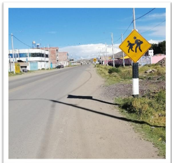
Foto 8: Progresiva 1392+542, demarcación del borde de calzada borrosa.
