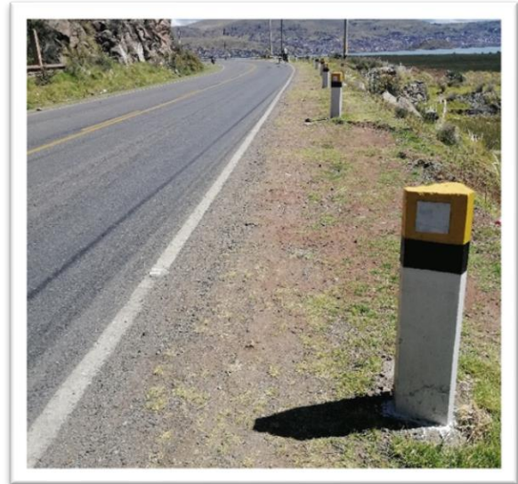
Foto 11: progresiva 1366+300, Poste delineador de concreto que es un riesgo ante un impacto, se deben cambiar por delineadores de fibra.
