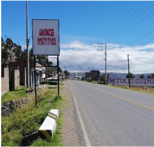
Foto 20: progresiva 1367+241.520, panel publicitario instalado a 0.9m del borde de calzada afectando la seguridad vial
