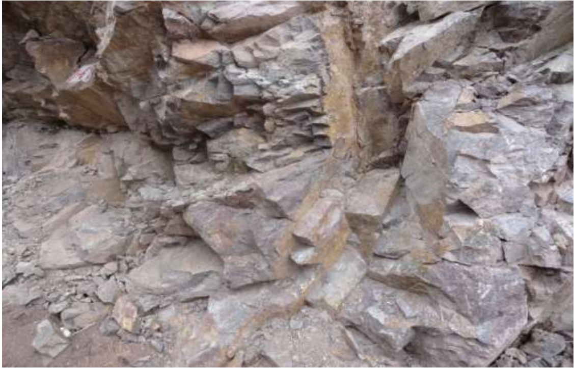
Foto 5. Presencia de discontinuidades en el corte de talud en la progresiva Km.2+250
