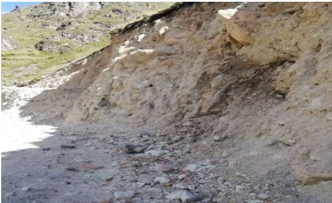
Figura 15. Existencia de material que se va desprendiendo de los taludes por efectos de las filtraciones de agua producto de las lluvias, Progresivas del 3+100 al 3+660
