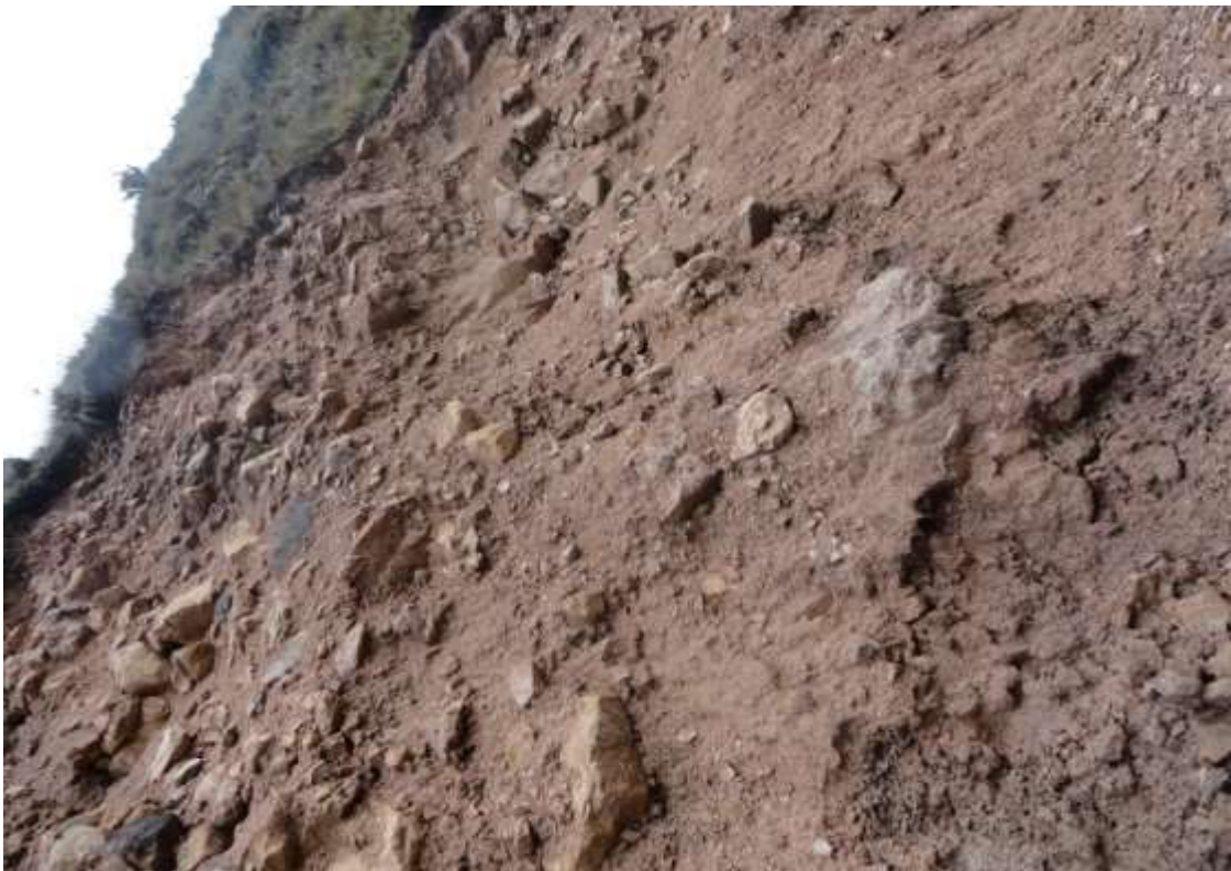
Foto 8. Corte de talud en suelo, Km. 2+100, observándose su grado de inestabilidad debido a la presencia de fragmentos de roca en el cuerpo de talud
