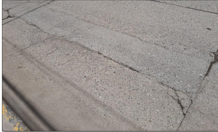
Figura 21. Falla en pavimento Rígido, “Parcheo Grande” de severidad Alta. Fuente: Elaborado por el equipo de trabajo
