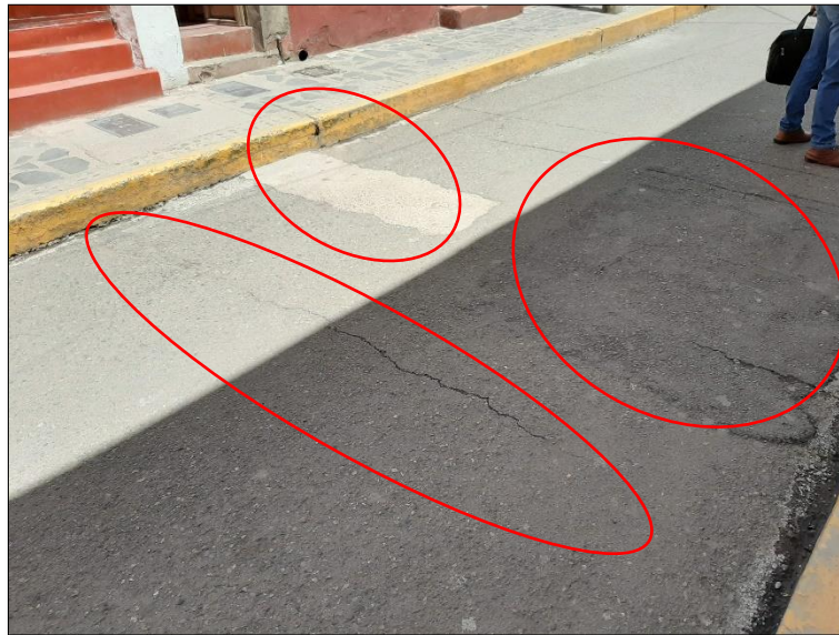
Figura 23. Falla en pavimento Mixto, “Grieta de reflexión de junta” de severidad Alta, y “Parches” de severidad Alta.
