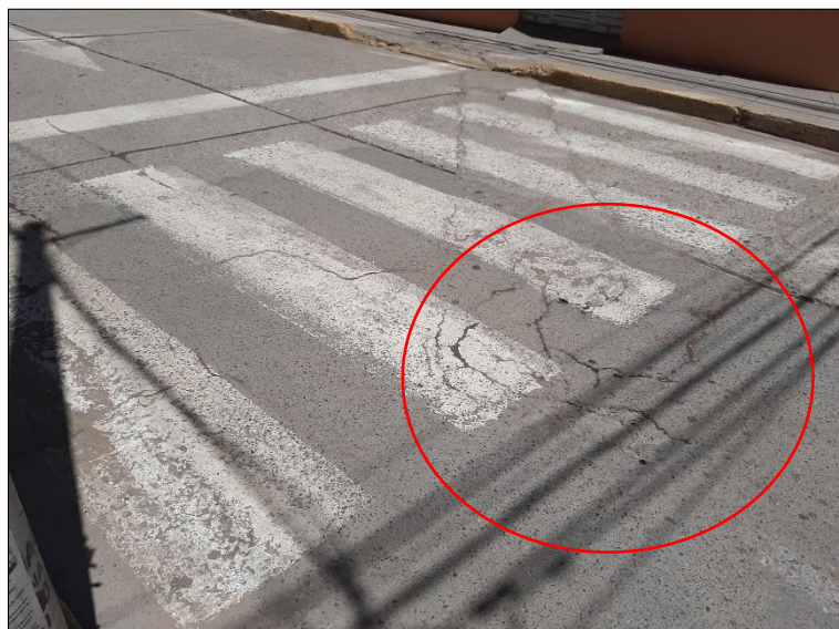
Figura 22. Falla en pavimento Rígido, “Mapa de Grietas” de severidad Alta. “Parcheo grande” de severidad alta, “Grietas lineales” de severidad Alta. Fuente: Elaborado por el equipo de trabajo
