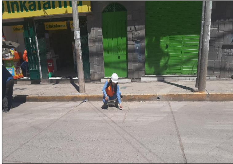
Figura 18. Ubicación y medición de las fallas presentes en el pavimento
