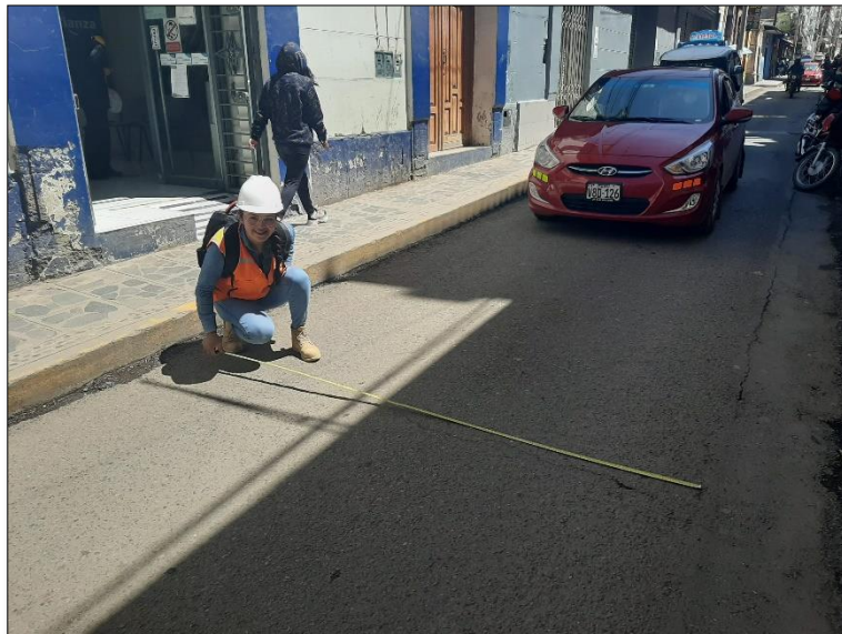
Figura 19. Ubicación y medición de la falla “Grieta de Reflexión de junta” de severidad Leve
