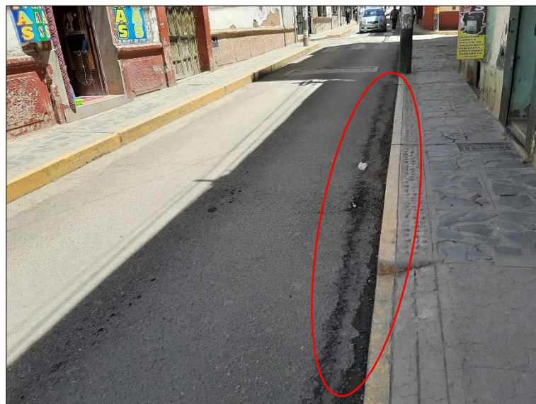
Figura 24. Falla en pavimento Mixto, “Grieta de borde” de severidad Alta.
