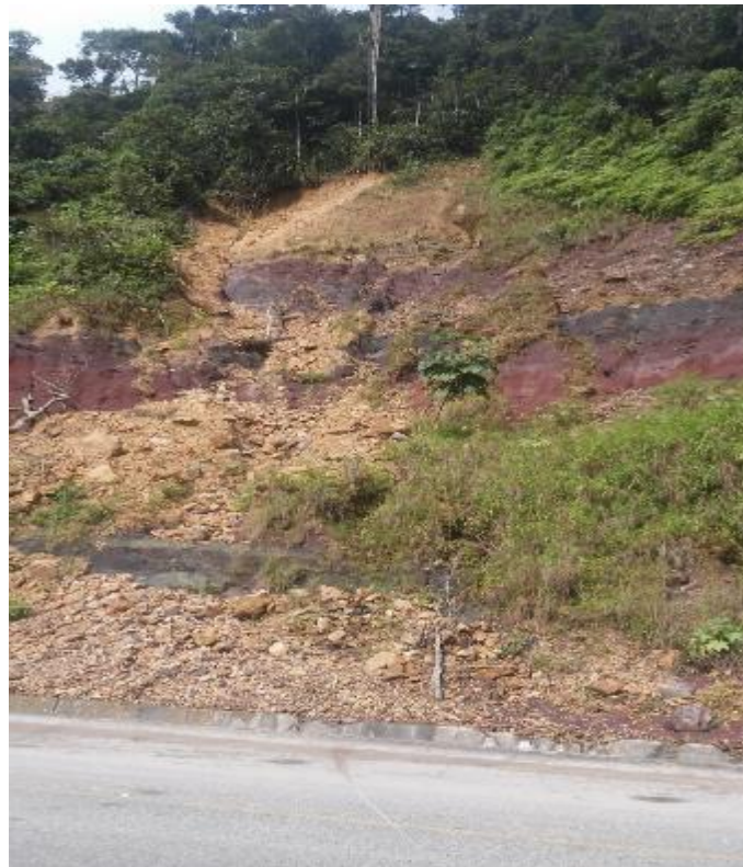
Figura N° 17: Sub tramo km 344+110 al km 344+160, talud superior adyacente al derrumbe mayor evidencia recientes deslizamientos por erosión.
