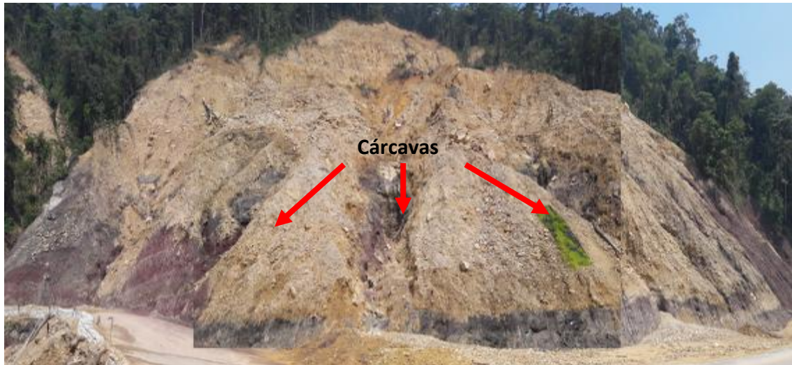
Figura N° 16: Cárcavas formadas en el talud superior de la plataforma, por el movimiento en masa por sobrecarga y la filtración de las aguas de precipitación, sub tramo km 344+250 al km 344+540. (Operadora SurPeru).
