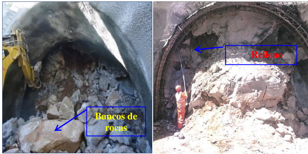
Figura 23. Relleno detritico, no consolidado, progresivas: 7+443.00 a 7+444.50. Fuente: Elaboración del autor
