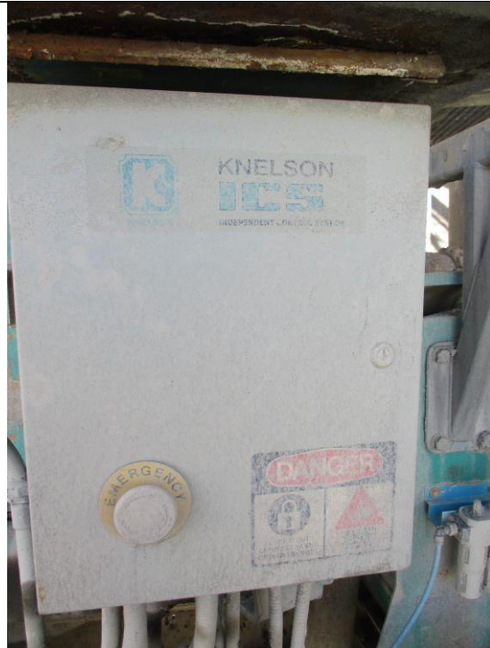
E17: Tablero de control del concentrador.
