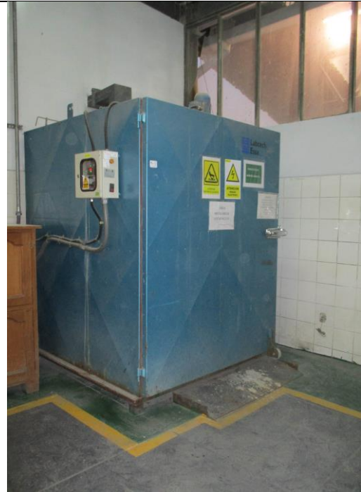
E29: Horno eléctrico.
