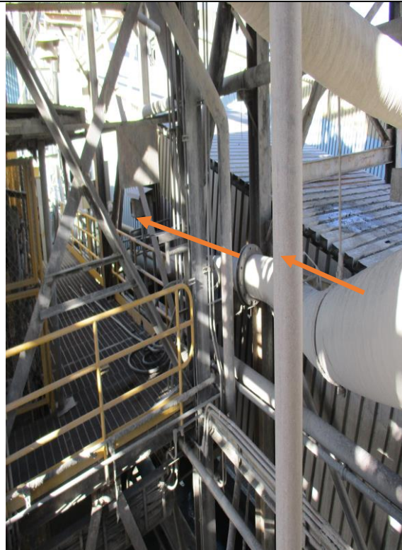
E15: Camino de carga recirculante de relave del Knelson al molino.
