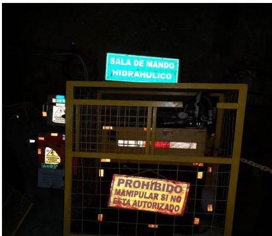
Sala de mandos hidráulico
