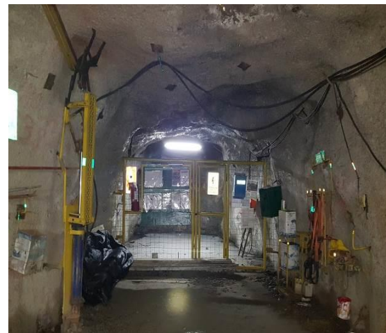
Sala de mandos hidráulico
