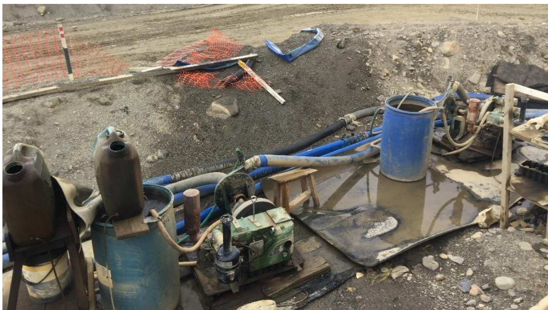
Imagen 4. Zona de Motobombas
