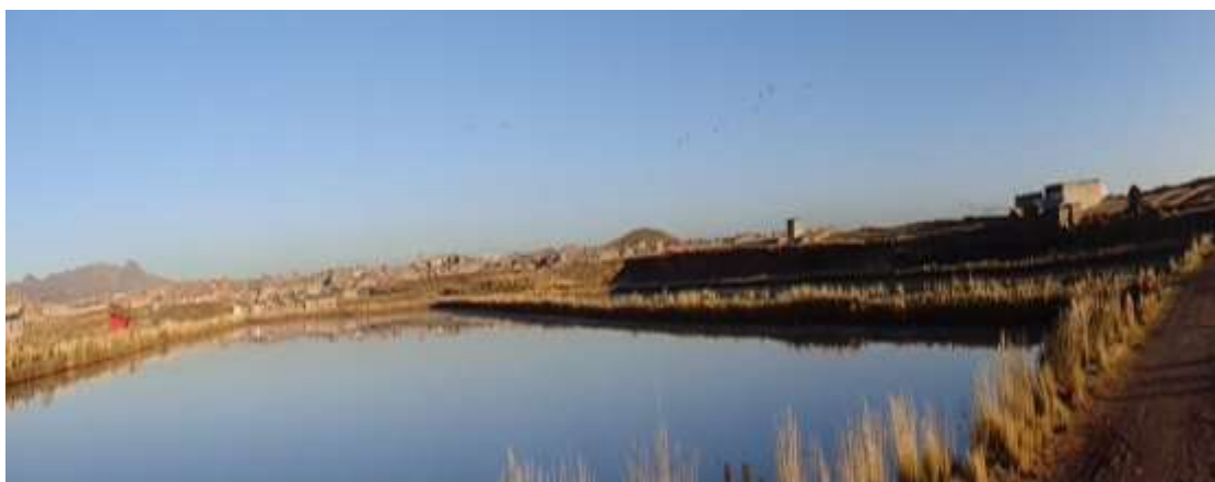
Figura 4. Vista de las lagunas de estabilización primaria de la planta de tratamiento de aguas servidas de la ciudad de Ilave, 09 de febrero del 2018
