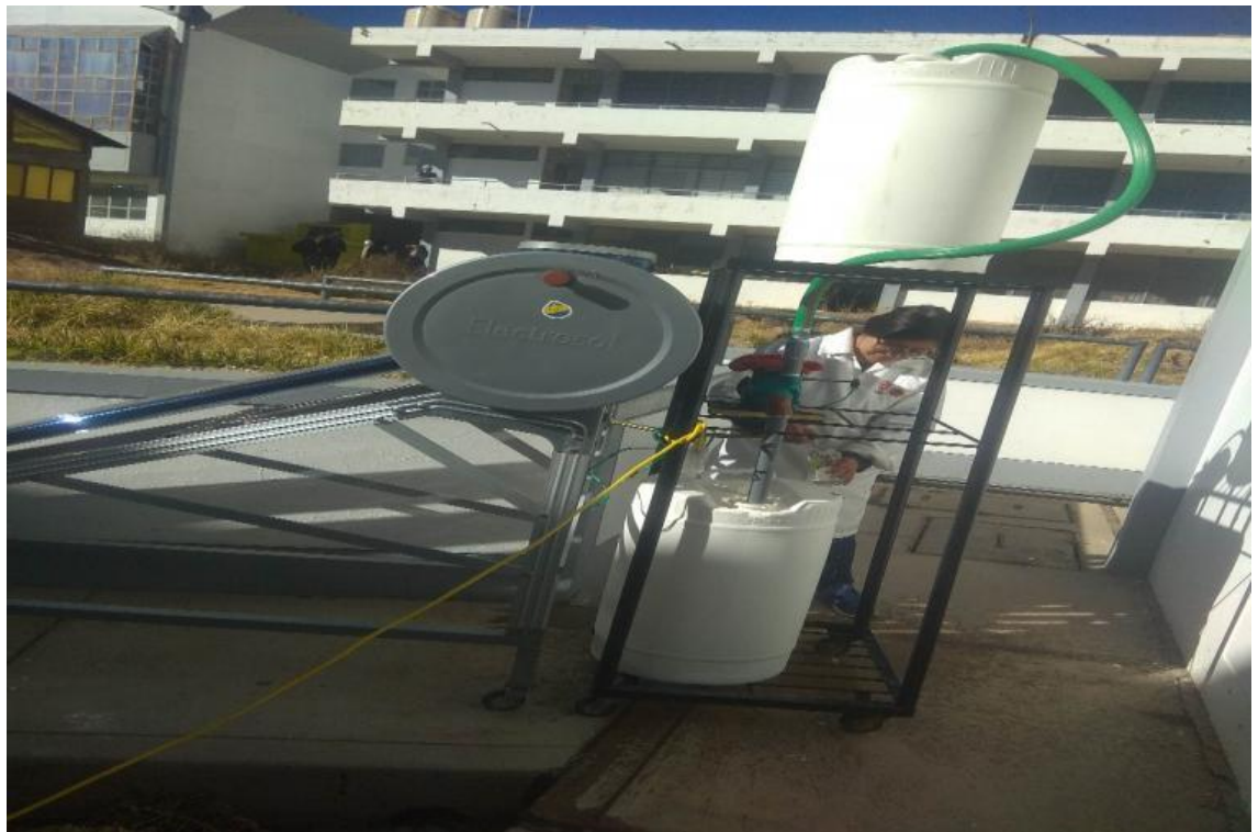
Figura E-2: Funcionamiento del equipo de proceso de oxidacion avanzada.
