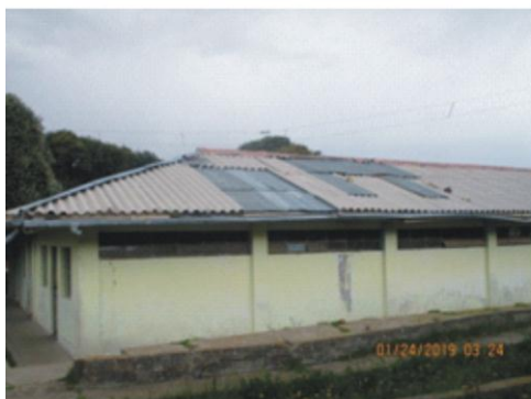
Vista de galpón con techo deteriorado
