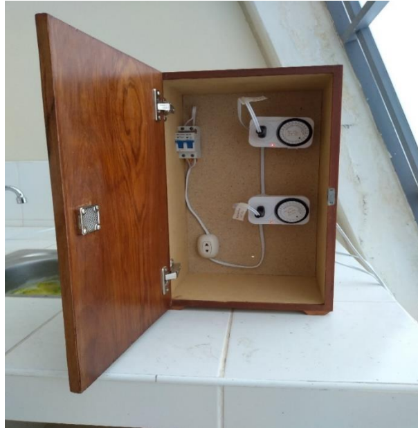
C.3 Imagen, Caja de control para temporizadores eléctricos, instalados.
