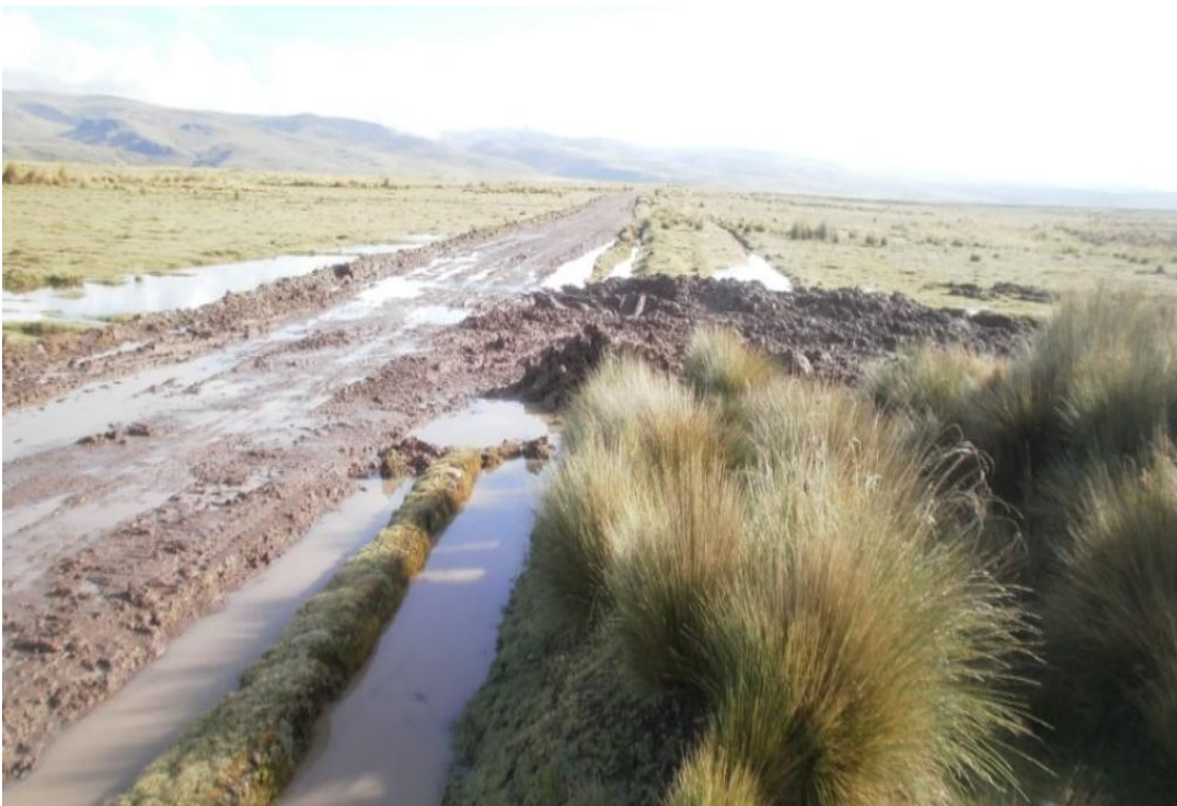
Fotografía 4: En la imagen se aprecia el deterioro de la carretera debido a la precipitación pluvial.
