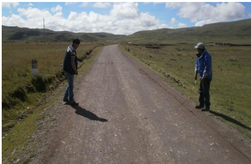
Fotografía 2: En la imagen se aprecia la verificación del ancho y espesor de la plataforma en la progresiva 13+000.
