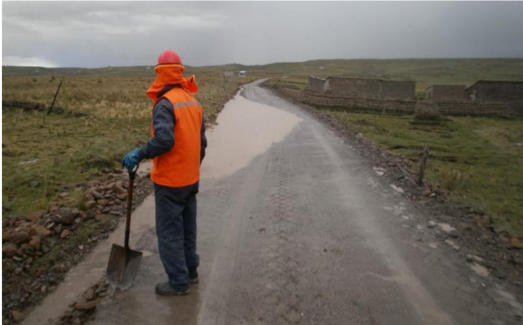
Fotografía 3: En la imagen se aprecia que por la erosión de la carretera se forman aniegos en la progresiva 14+500.
