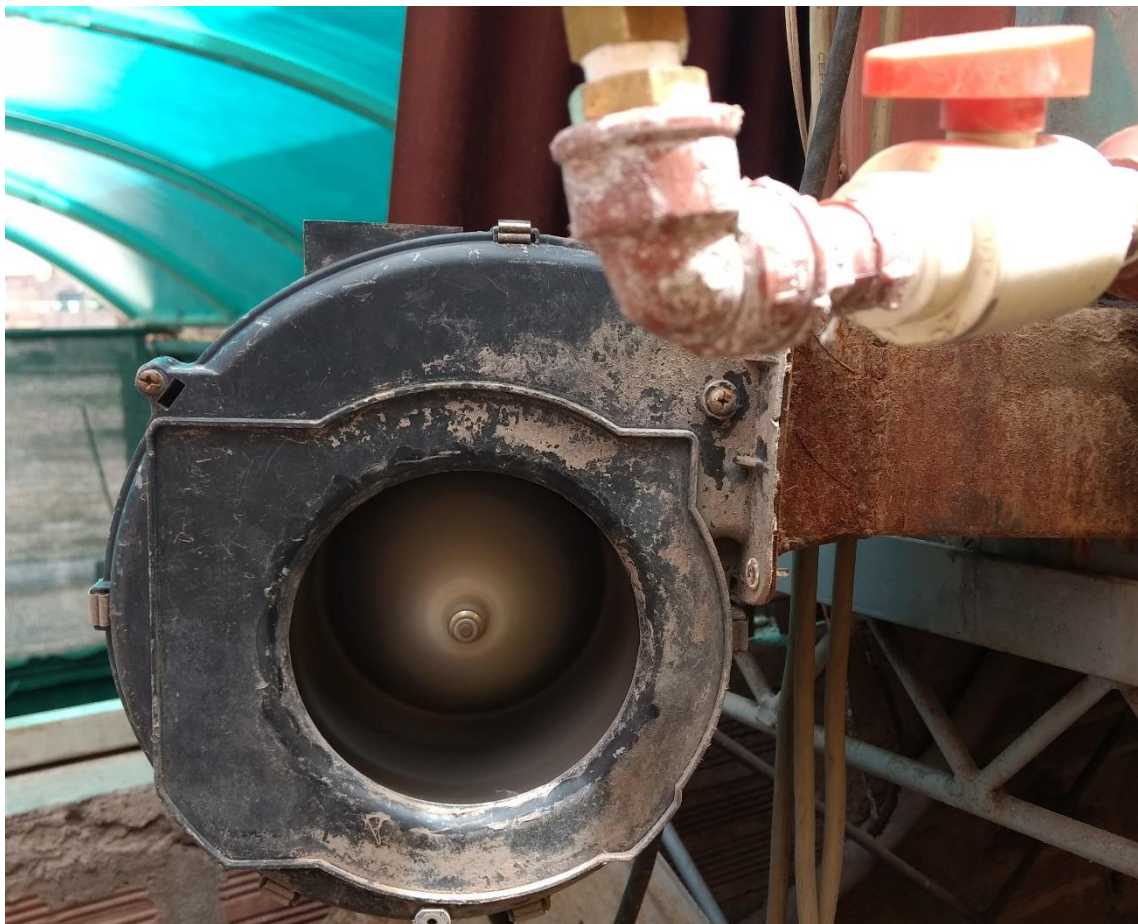
Foto del ventilador
