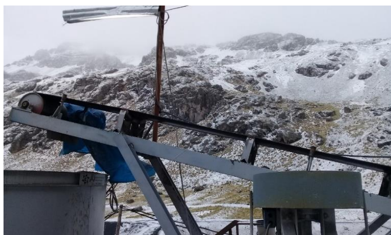
Figura N° 22: Se observa la faja transportadora N° 1 del circuito de Chancado de Planta San Carlos.
