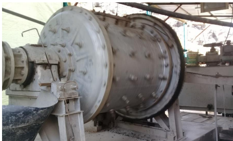
Figura N° 26: Se observa el Molino COMESA 4' * 4' Circuito de Molienda de la Planta San Carlos.
