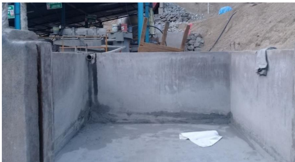
Figura N° 31: Se observa las cochas de concentrado de la Planta San Carlos.
