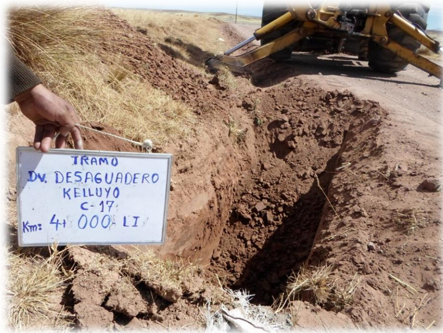
FOTO N°02: En la calicata N°02 se observa un suelo limoso de color pardo claro de mediana plasticidad, al lado izquierdo de la carretera en la prog. 4+000.
