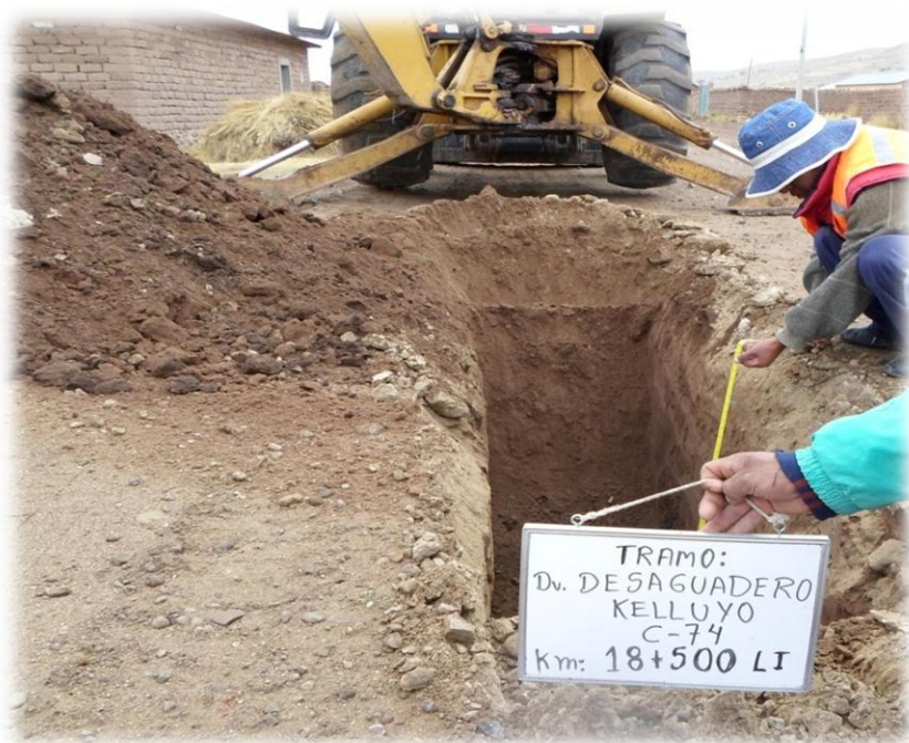
FOTO N° 06: En la calicata N° 74 se observa un suelo areno arcilloso de color pardo con una plasticidad media a alta, al lado izquierdo de la carretera de la prog. 18+500.
