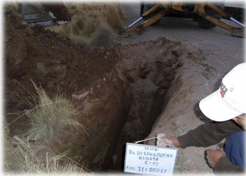
FOTO N° 05: En la calicata N° 45 se observa un suelo areno limoso de color pardo oscuro, al lado izquierdo de la carretera de la prog. 11+000.
