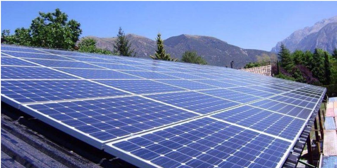
Figura 2.18. Conjunto de paneles solares, Expo 2005 Aichi Japan, Japón
