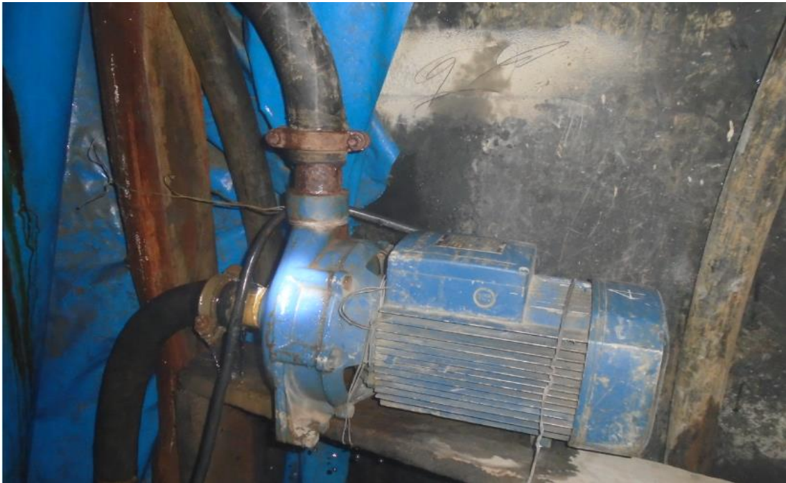
Fig. 2. Fotografías de las bombas
