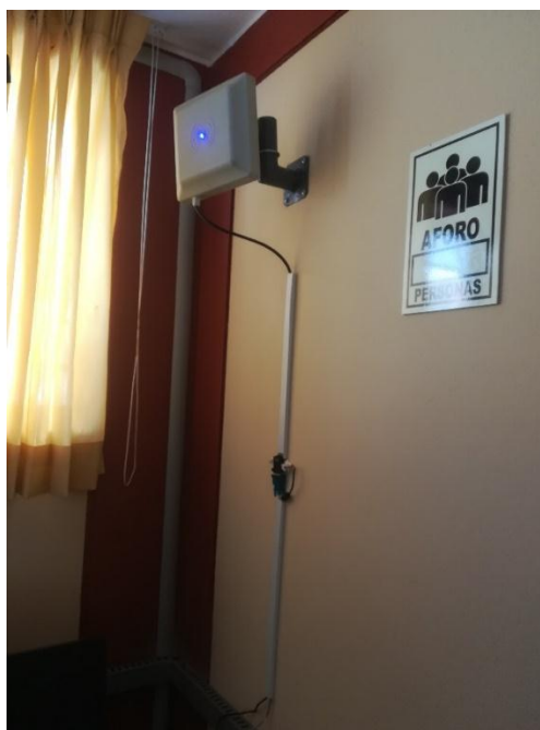
Figura 3 11 - Antena RFID empotrado a la pared
