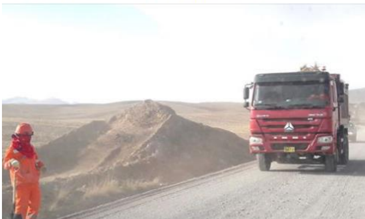
Nota de prensa publicada acerca del avance de la ejecución de la carretera Checca Mazocruz
