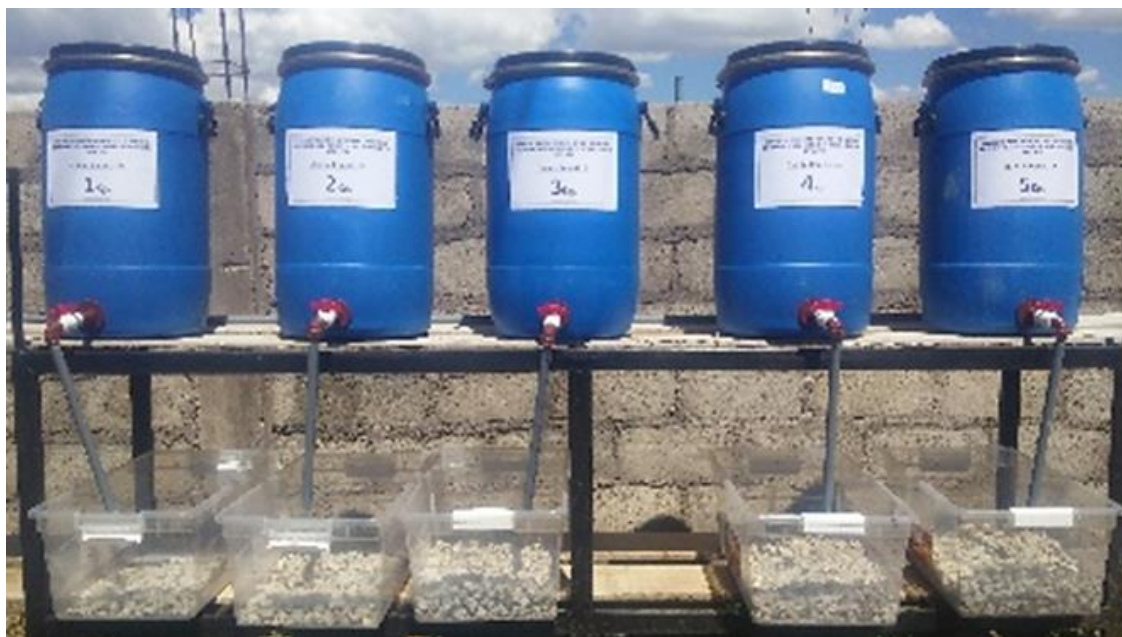
Figura 17. Instalación concluida del sistema de tratamiento de aguas residuales verdes del centro de beneficio animal Azoguini (noviembre 2018 a agosto 2019)
