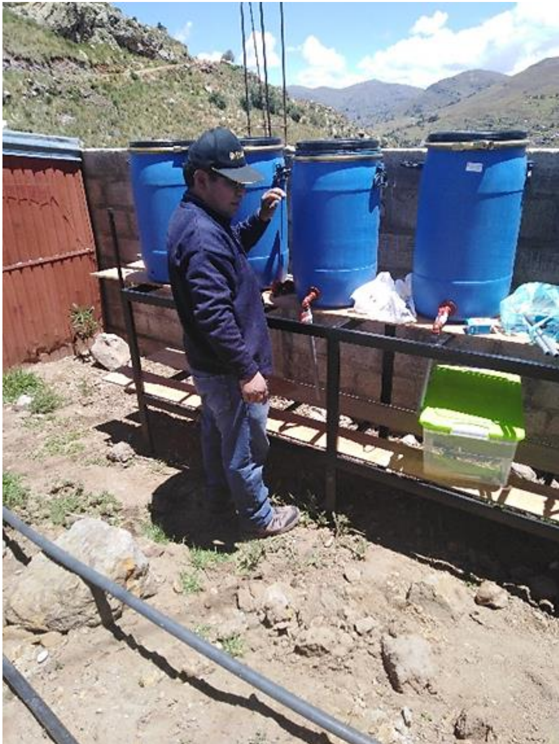
Figura 16. Instalación de tanques para el agua residual verde del centro de beneficio animal Azoguini (noviembre 2018 a agosto 2019)
