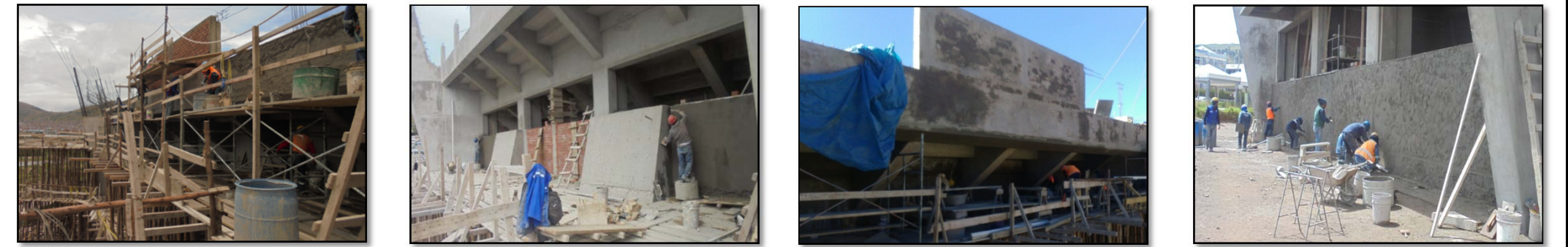
Fotografía 233. Seguimiento de partidas en obra (fuente propia) Fotografía 234. Seguimiento de partidas en obra (fuente propia) Fotografía 235. Seguimiento de partidas en obra (fuente propia) Fotografía 236. Seguimiento de partidas en obra (fuente propia)
