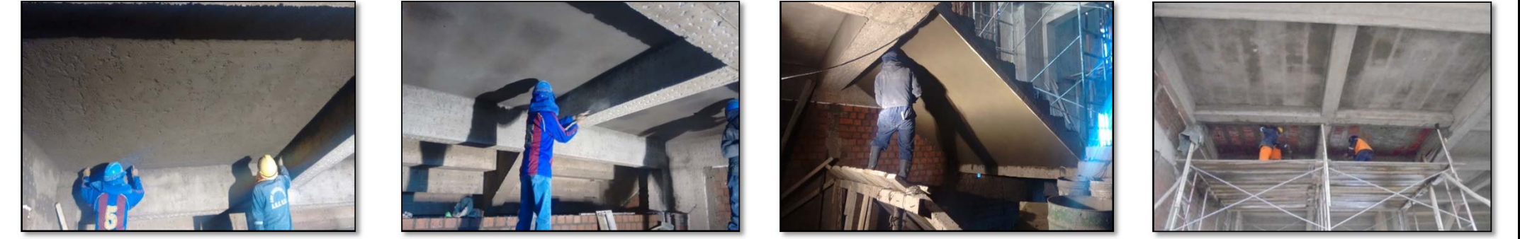
Fotografía 261. Seguimiento de partidas en obra (fuente propia) Fotografía 262. Seguimiento de partidas en obra (fuente propia) Fotografía 263. Seguimiento de partidas en obra (fuente propia) Fotografía 264. Seguimiento de partidas en obra (fuente propia)
