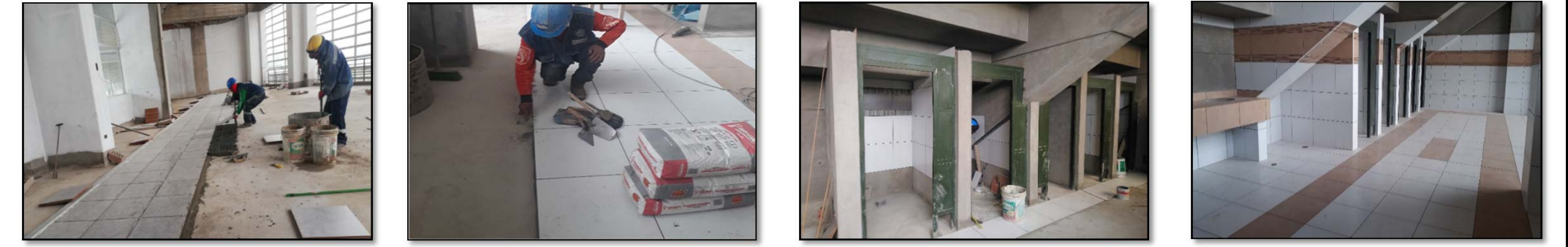
Fotografía 273. Seguimiento de partidas en obra (fuente propia) Fotografía 274. Seguimiento de partidas en obra (fuente propia) Fotografía 275. Seguimiento de partidas en obra (fuente propia) Fotografía 276. Seguimiento de partidas en obra (fuente propia)
