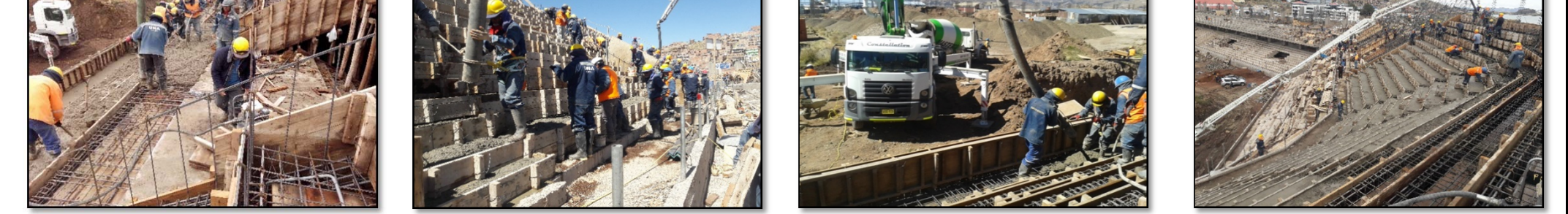
Fotografía 133. Seguimiento de partidas en obra (fuente propia) Fotografía 134. Seguimiento de partidas en obra (fuente propia) Fotografía 135. Seguimiento de partidas en obra (fuente propia) Fotografía 136. Seguimiento de partidas en obra (fuente propia)
