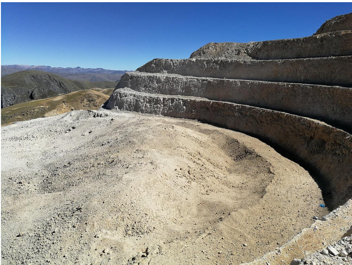
Foto 26. Después de la voladura SM. Fuente: Autor del informe de trabajo profesional.
