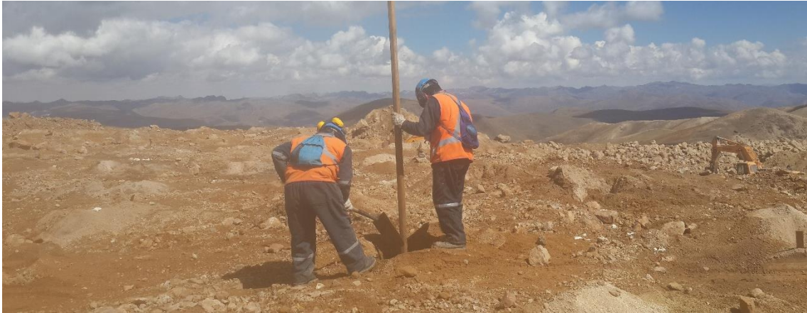
Foto 22. Tapado de taladros y taconeado con madera. Fuente: Autor del informe de trabajo profesional.
