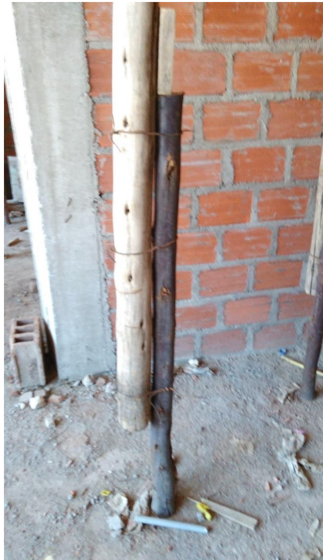
Fotografía 19: Se puede observar el empalme de un puntal con otro por falta de longitud requerida.
