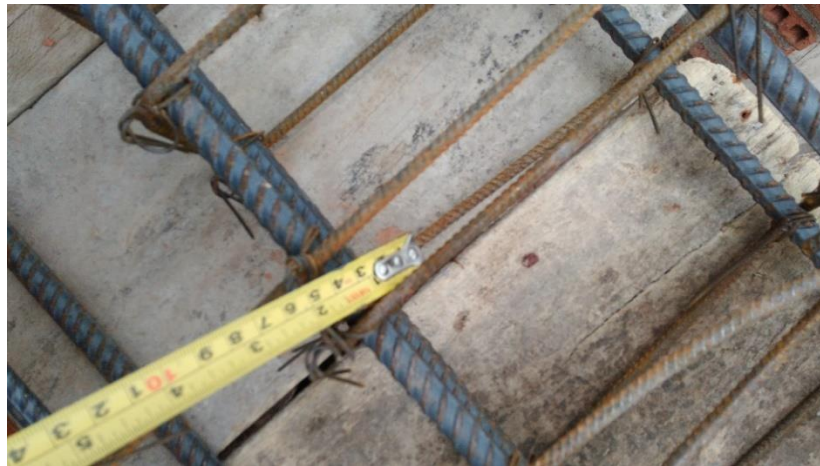
Fotografía 52: Se muestra la medición de los ganchos en estribos y el diámetro de las varillas utilizadas en el refuerzo.
