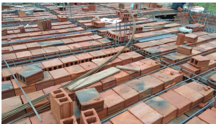
Fotografía 92: Vista de las unidades de albañilería colocados para su posterior colocación del acero de temperatura.
