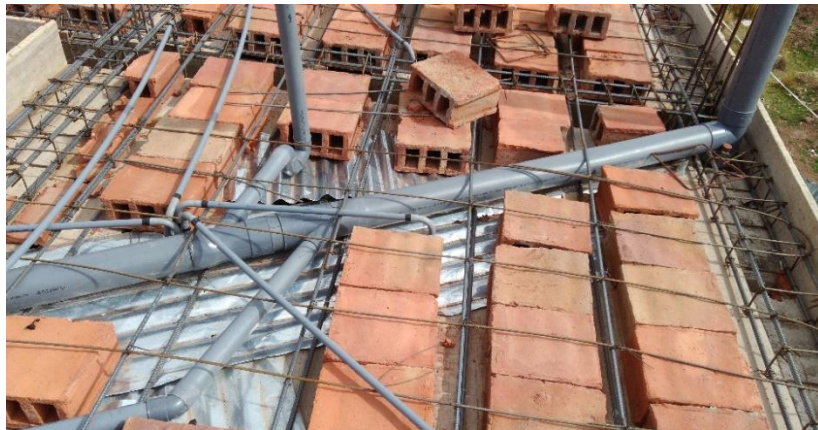
Fotografía08: Se muestra la colocación de tuberías de desagüe con varios errores técnicos.
