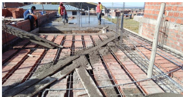
Fotografía10: Se muestra desperdicio de concreto por el mal manejo de transporte.
