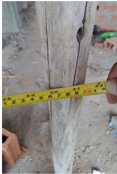
Fotografía 24: Se muestra la medición del espaciamiento de puntales, diámetro de los puntales.
