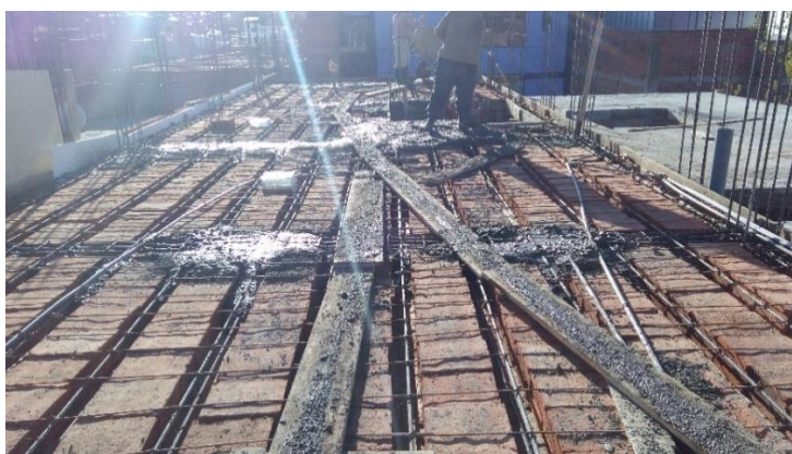
Fotografía 110: Vista del desperdicio del concreto en colocación del mismo.
