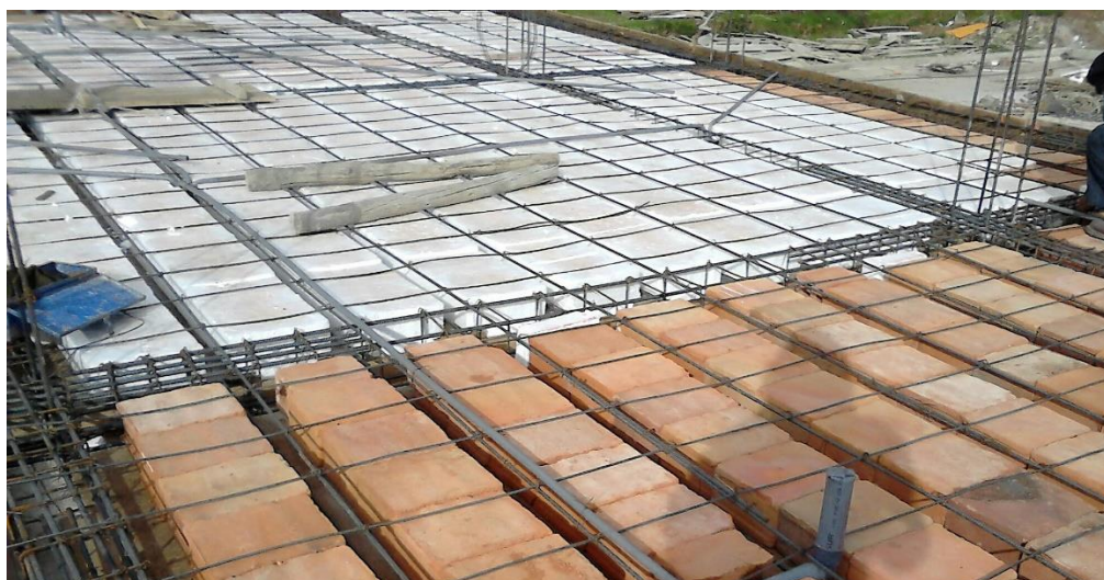
Fotografía 50: Se puede observar dos tipos de unidades de albañilería como material aligerado.
