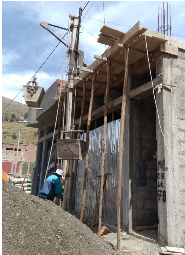
Fotografía06: Se muestra fachada de la vivienda 02, con el armado del winche eléctrico para su transporte del concreto.
