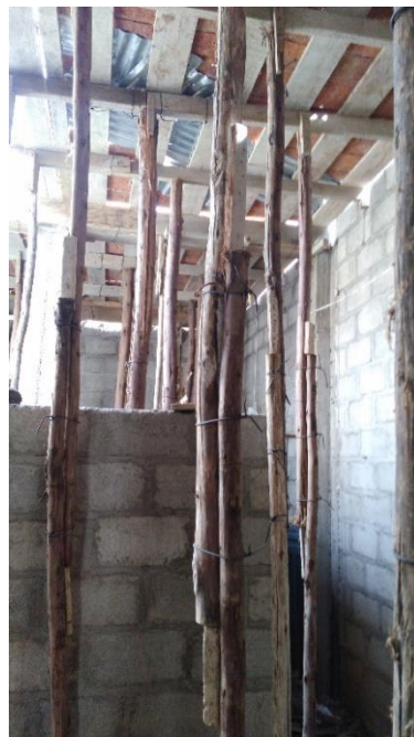
Fotografía09: Se aprecia los puntales colocados de manera incorrecta y un empalme forzado.
