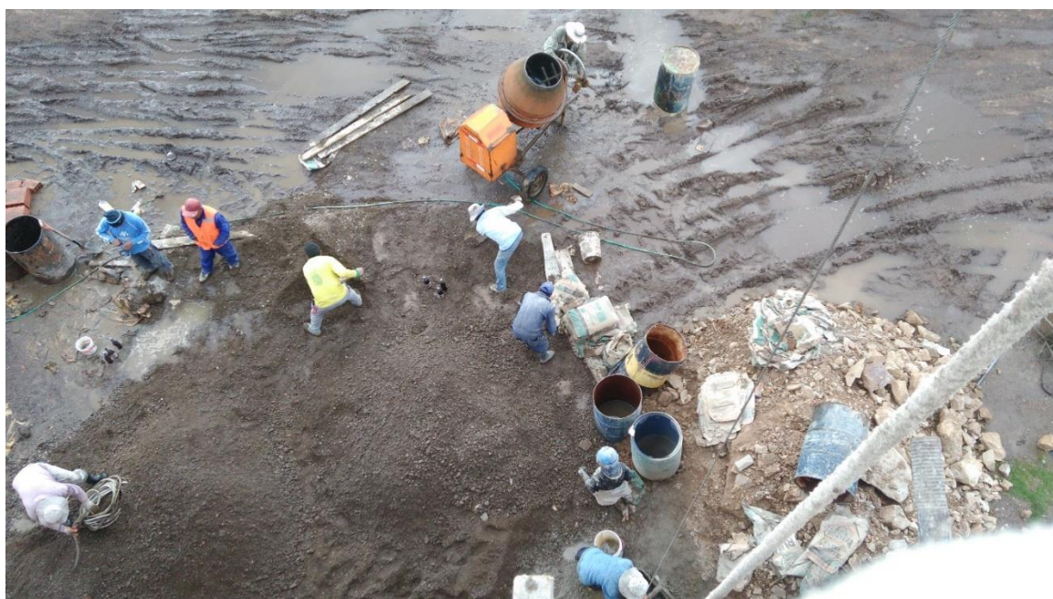
Fotografía 102: Se aprecia que el hormigón fue descargado en superficie saturado por presencia de lluvias.
