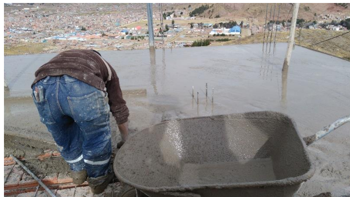
Fotografía 26: Se muestra la colocación del concreto, así como el buggy como medio de transporte.
