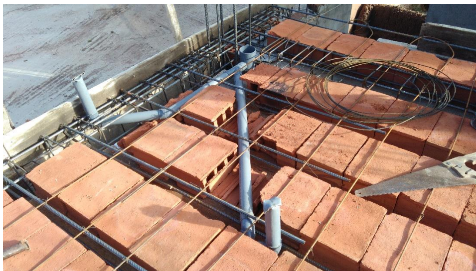
Fotografía 46: Vista de la tubería de desagüe.
