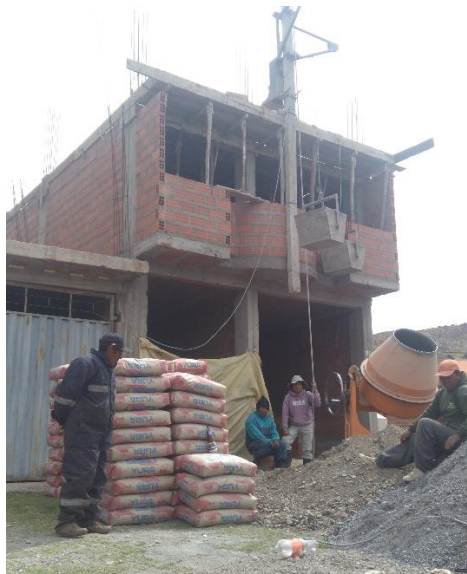
Fotografía11: Se presenta la fachada de la vivienda 03, se puede observar que el tronco del winche eléctrico se encuentra suspendido, tomando como apoyo el encofrado.
