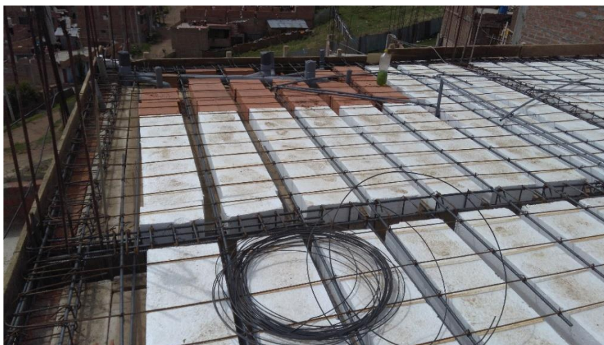
Fotografía 39: Se aprecia dos tipos de albañilería.
