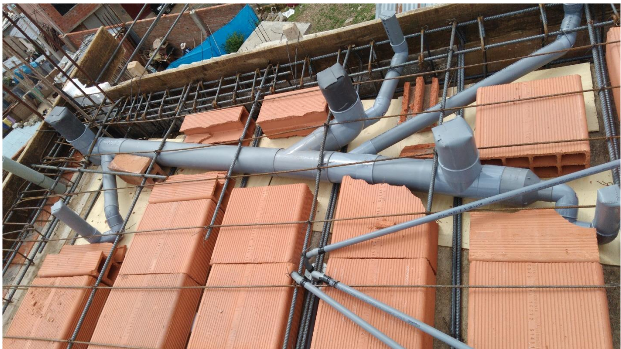
Fotografía 42: Vista de la instalación y ubicación de las tuberías de desagüe.
