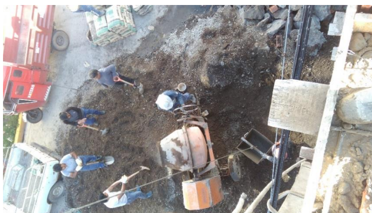
Fotografía 111: Sistema de abastecimiento y mezclado de los materiales para producción de concreto.
