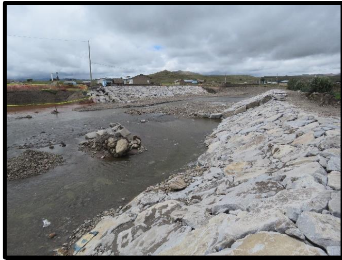
Imagen 2. Retraso en la Ejecución de partidas por precipitaciones pluviales, materiales y proceso constructivo deficiente en la construcción de las defensas ribereñas.
