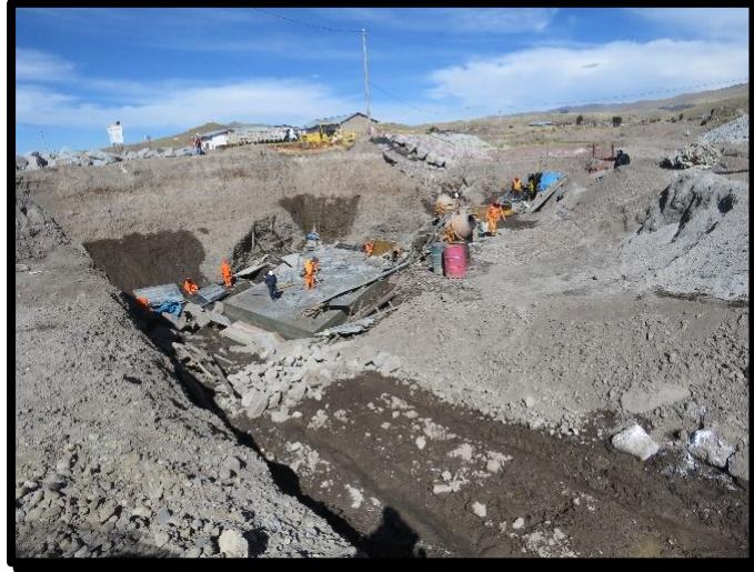
Imagen 4. Adicional de Obra, construcción de la falsa zapata, riesgo produciendo ampliaciones de plazo y mayores gastos.
