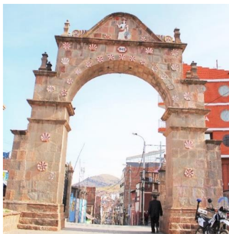
Figura 107: Pátinas negras en la parte superior del Arco Deustua. Fuente: Foto tomada por el grupo de trabajo.
