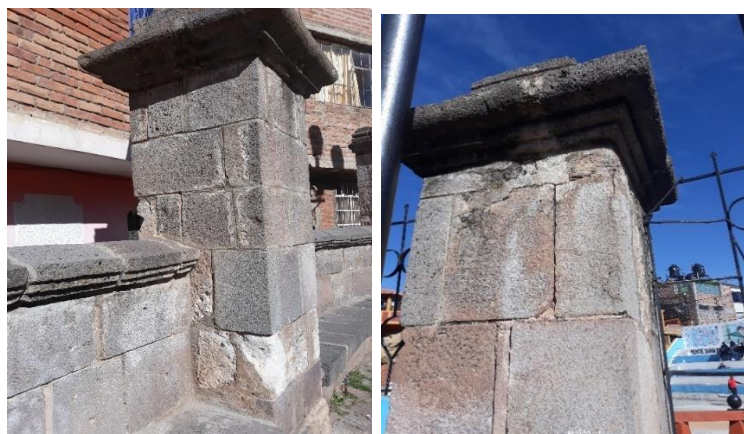
Figura 122: Grietas y fisuras en los pilares de la media glorieta este Fuente: Elaborado por el equipo de trabajo.
