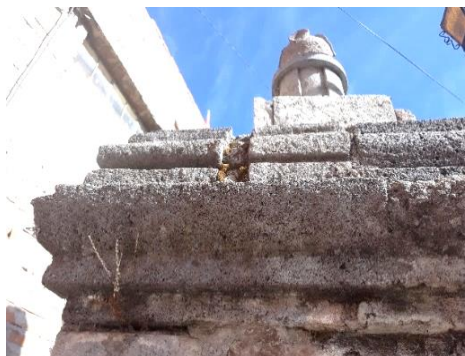
Figura 135: Pátinas biológicas en los capiteles de los pilares de la media glorieta este Fuente: Foto tomada por el equipo de trabajo.
