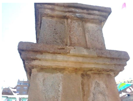
Figura 129: Eflorescencia de la piedra en el pilar de la media glorieta este Fuente: Elaborado por el equipo de trabajo.
