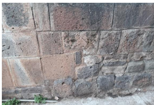
Figura 120: Deformaciones debido a la mala colocación de cimientos y muros. Fuente: Elaborado por el equipo de trabajo.
