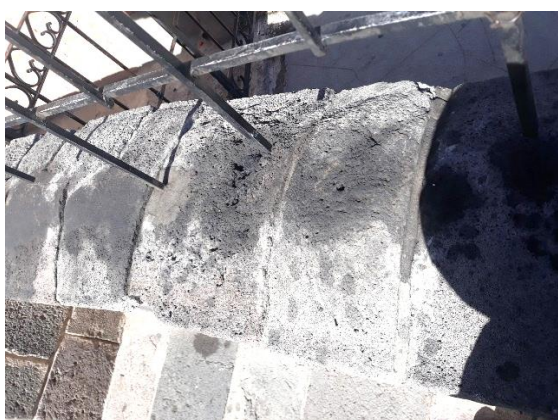
Figura 114: Suciedad proveniente del pintado de la reja en el muro contiguo. Fuente: Elaborado por el equipo de trabajo.
