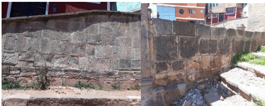
Figura 146: Erosión en los muros de la media glorieta oeste Fuente: Foto tomada por el equipo de trabajo.
