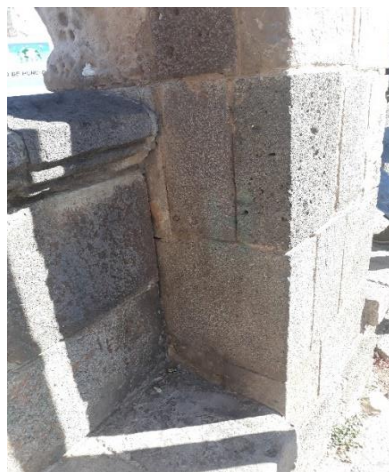
Figura 111: Humedades en las esquinas de los pilares y muros. Fuente: Elaborado por el equipo de trabajo.
