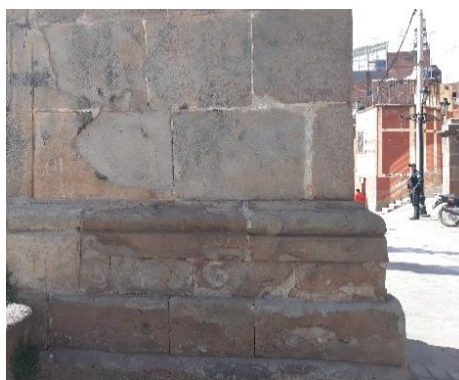
Figura 103: Desprendimiento en la basa de la jamba del Arco Deustua. Fuente: Foto tomada por el grupo de trabajo
