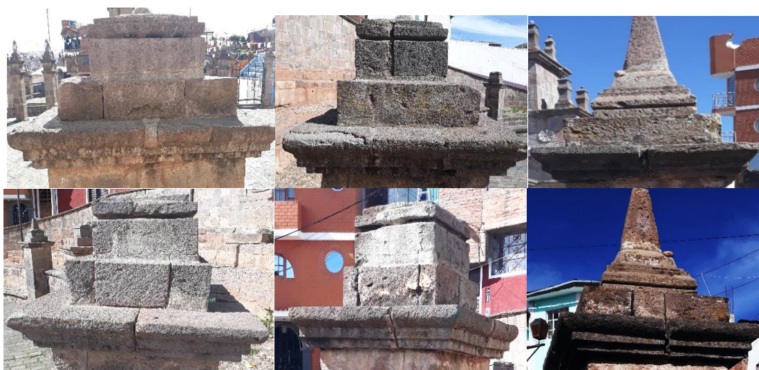
Figura 144: Erosión en los capiteles de la media glorieta Oeste. Fuente: Foto tomada por el equipo de trabajo.
