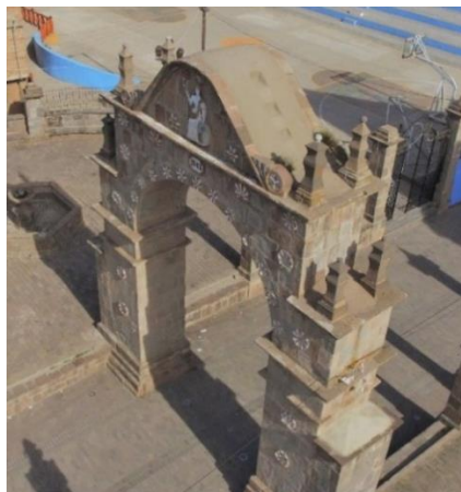
Figura 95: Suciedad en el trasdós del Arco Deustua. Fuente: Foto tomada por el equipo de trabajo.
