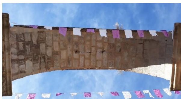
Figura 105: Pátinas blancas o eflorescencias en el Intradós del Arco Deustua Fuente: Foto tomada por el grupo de trabajo.
