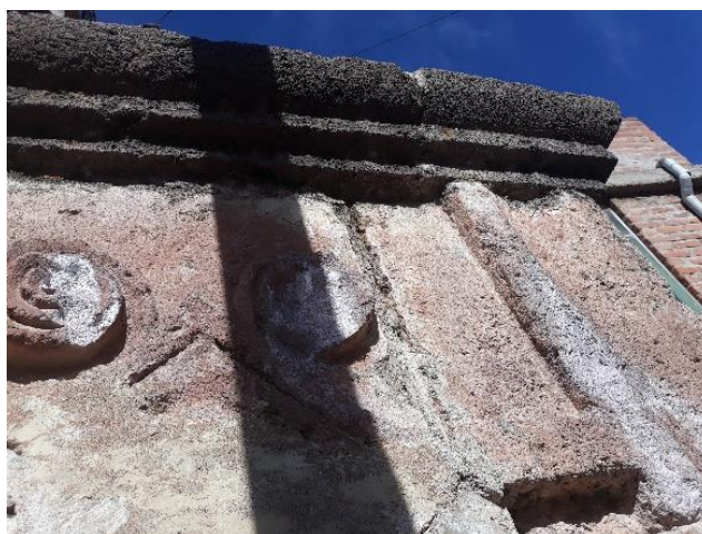
Figura 116: Erosión de las figuras del pilar 4 de la media glorieta este Fuente: Elaborado por el equipo de trabajo.
