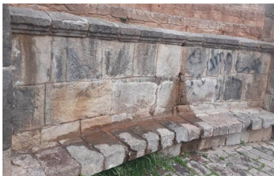
Figura 140: Humedad de filtración en el muro de la media glorieta oeste Fuente: Foto tomada por el equipo de trabajo.
