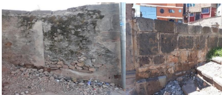
Figura 155: Erosiones mecánicas en los muros de la media glorieta oeste. Fuente: Foto tomada por el equipo de trabajo.
