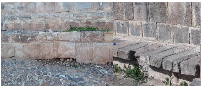
Figura 153: Desprendimientos en los muros de la media glorieta oeste Fuente: Foto tomada por el equipo de trabajo.
