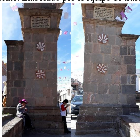
Figura 97: Erosión en las jambas del Arco Deustua. Fuente: Foto tomada por el equipo de trabajo.
