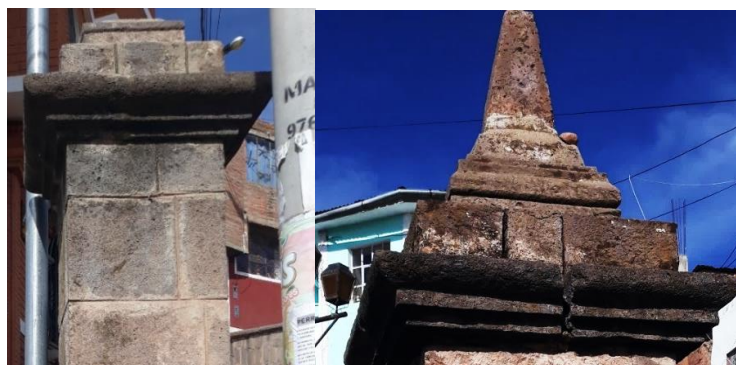
Figura 160: Pátina negra en los capiteles de la media glorieta oeste Fuente: Foto tomada por el equipo de trabajo.
