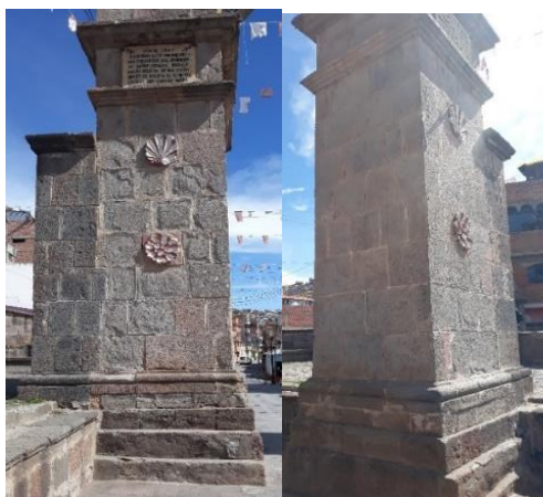
Figura 100: Deformación de las jambas del Arco Deustua Fuente: Foto tomada por el equipo de trabajo.
