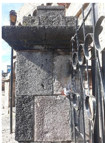
Figura 133: Corrosión y oxidación por rejas ancladas a los pilares. Fuente: Foto tomada por el equipo de trabajo.
