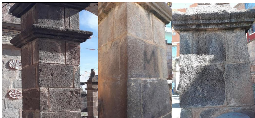
Figura 162: Pátina blanca en los pilares de la media glorieta oeste Fuente: Foto tomada por el equipo de trabajo
