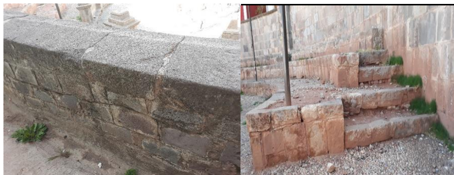
Figura 149: Deformaciones en los muros de la media glorieta oeste Fuente: Foto tomada por el equipo de trabajo.
