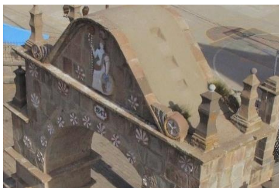
Figura 109: Pátinas biológicas en la parte superior del trasdós del Arco Deustua Fuente: Foto tomada por el equipo de trabajo.
