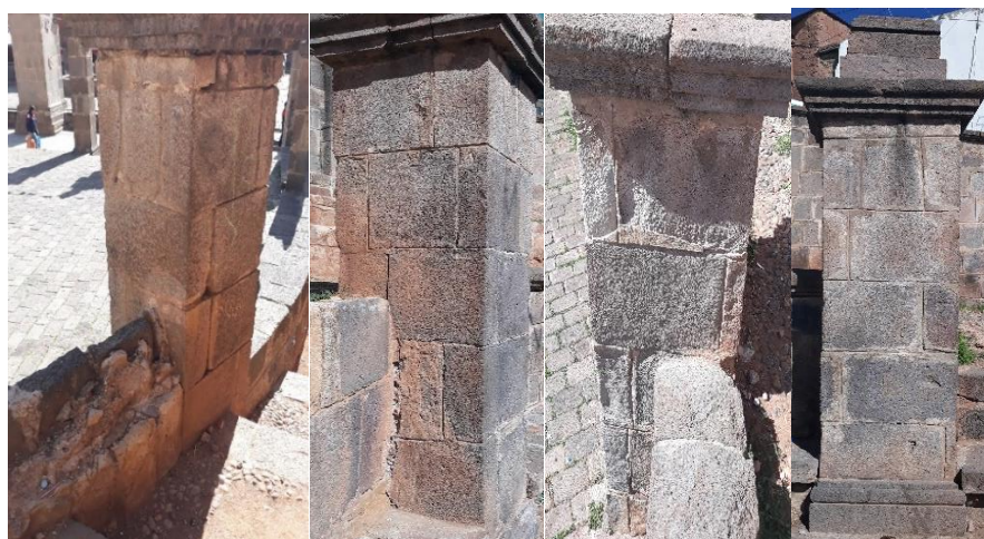
Figura 145: Erosión en los fustes de la media glorieta oeste. Fuente: Foto tomada por el equipo de trabajo.
