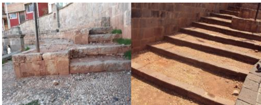
Figura 142: Suciedad en los graderíos de la media glorieta Oeste Fuente: Elaborado por el equipo de trabajo.
