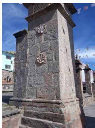
Figura 102: Grietas y fisuras en la jamba Este del Arco Deustua Fuente: Foto tomada por el equipo de trabajo.
