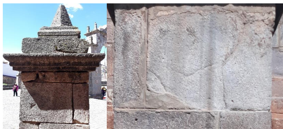
Figura 151: Grietas y fisuras en los pilares de la media glorieta oeste Fuente: Foto tomada por el equipo de trabajo.
