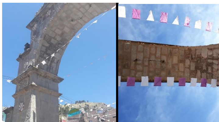
Figura 93: Humedades en el Intradós del Arco Deustua Fuente: Foto tomada por el equipo de trabajo.
