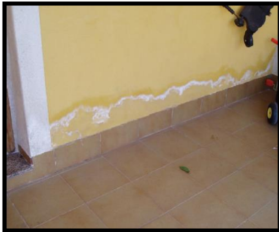
Figura N° 70: Viviendas con eflorescencia en los acabados.
