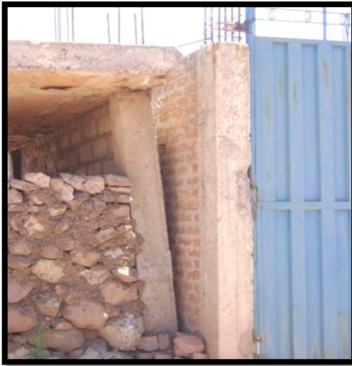
Figura N° 48: Presencia de asentamiento en una vivienda.
