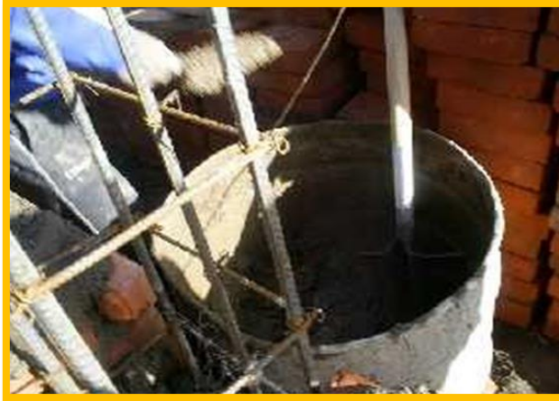
Figura N° 86: Mortero sin el correcto mezclado.
