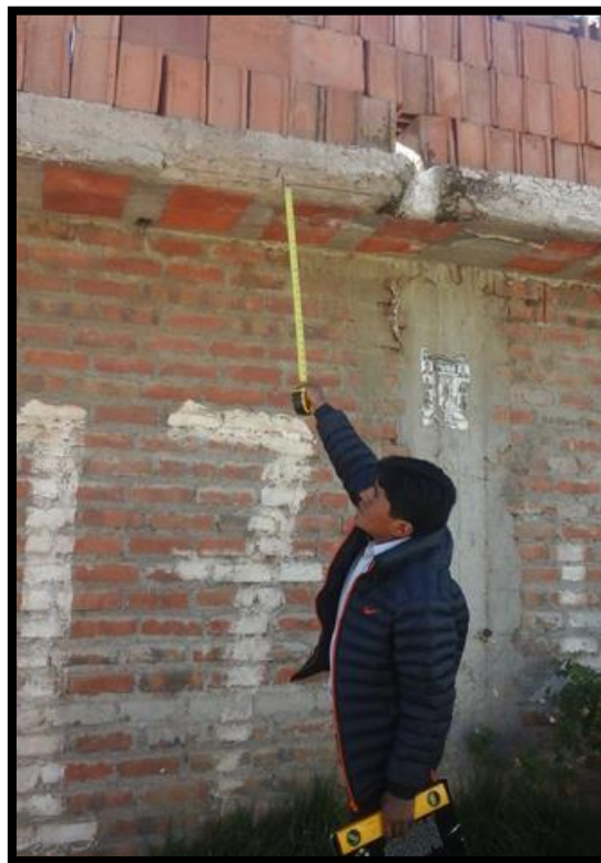
Figura N° 129: Desprendimiento de gran tamaño en las losas.
