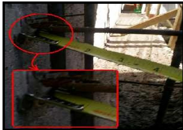
Figura N° 105: Construcción de vigas y columnas sin recubrimiento mínimo.
