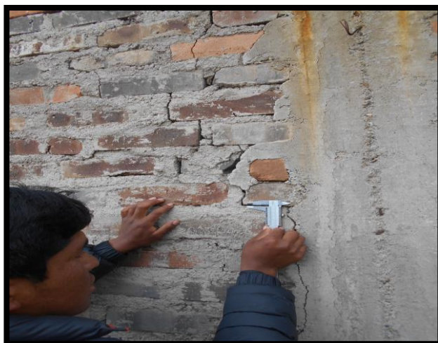
Figura N° 27: Identificación del tipo de fisura
