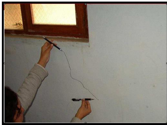
Figura N° 25: Fisura en una Vivienda del Barrio Paxa
