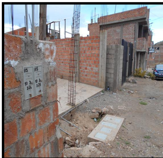
Figura N° 52: Resultado del estado de las varillas de acero.
