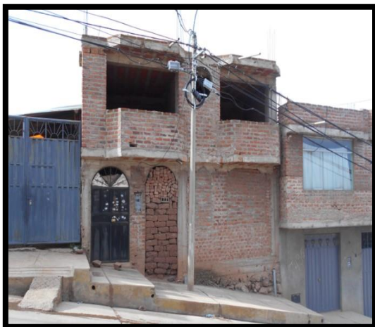
Figura N° 14: Puerta clausurada, que evidencia la falta de asesoría técnica en el diseño de la vivienda. Vivienda unifamiliar (Barrio Paxa: Jr. Sillustani)
