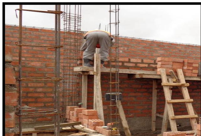
Figura N° 101: Aceros sin ningún control de plomada.
