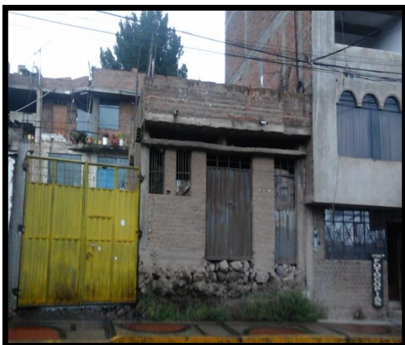
Figura N° 59: Viviendas sin junta sísmica y losas a desnivel
