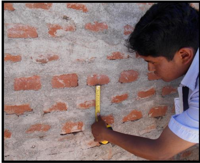
Figura N° 88: Viviendas con espesores de juntas no permitidas según RNE.
