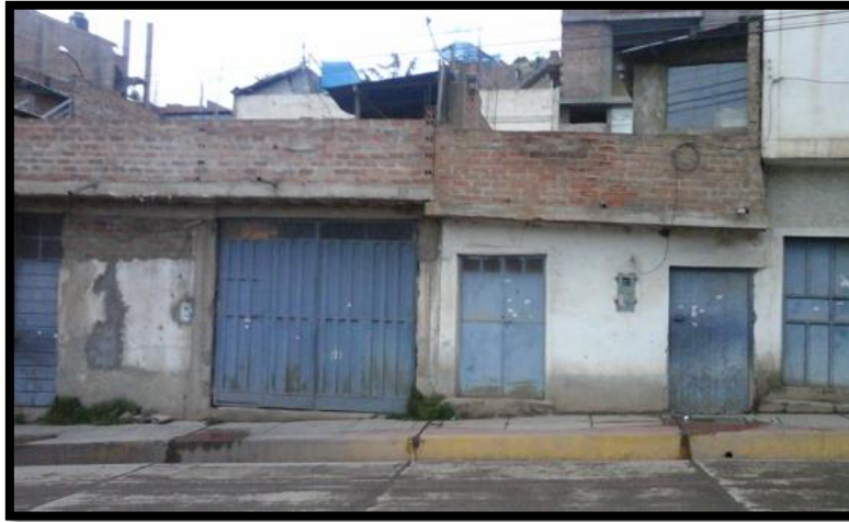
Figura N° 128: Grietas longitudinales y desnivel de la viga.
