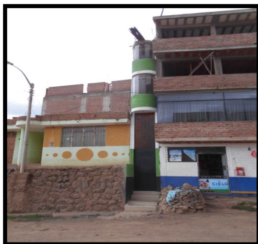
Figura N° 57: Viviendas sin junta sísmica y losas a desnivel
