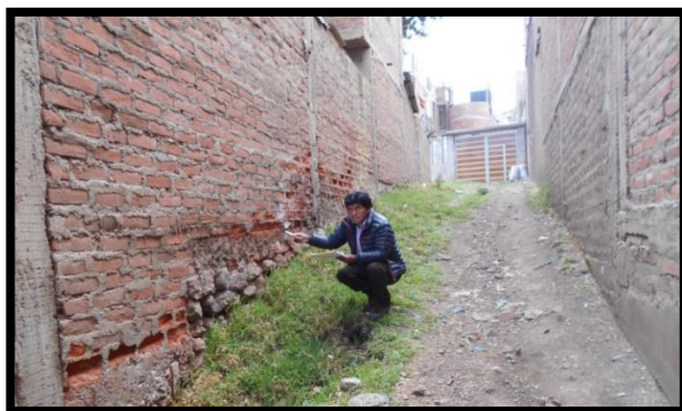
Figura N° 68: Viviendas con presencia de eflorescencia.
