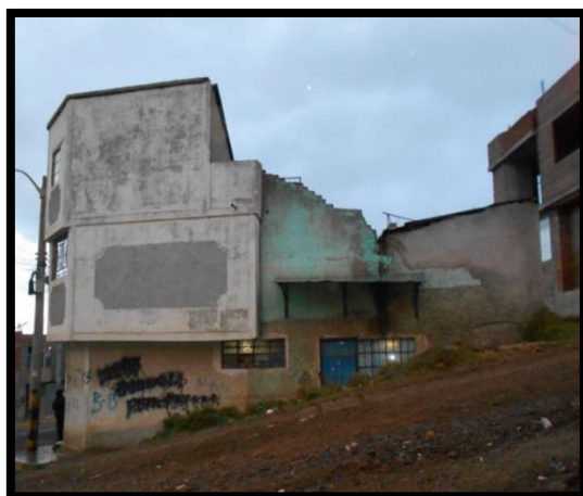
Figura N° 18: Los experimentos han demostrado que no es adecuado emplear acero trefilado sin escalón de fluencia, como refuerzo estructural, debido a que la energía elástica que acumula este acero se disipa violentamente al fracturarse, lo que origina un deterioro severo en la albañilería y una reducción sustancial de la resistencia. (Barrio Ricardo Palma)
