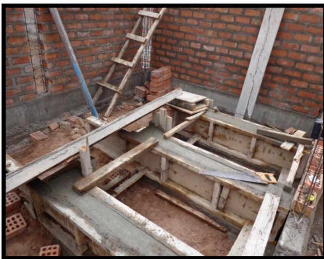
Figura N° 83: Construcción de sobre cimiento sin cumplir el RNE.
