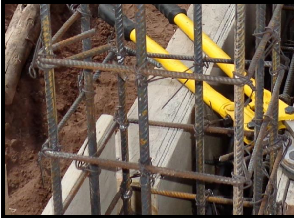
Figura N° 99: Viviendas que no se respetó el RNE.
