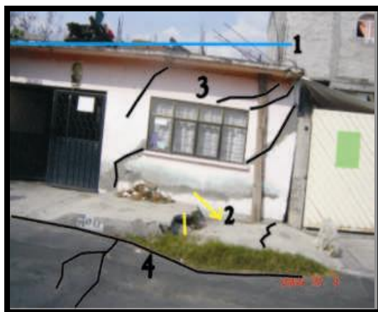
Figura N° 35: Hundimiento que tiene la Vivienda
