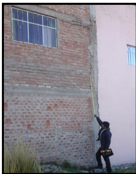
Figura N° 127: Grietas verticales de gran tamaño en Columnas.H.U. Simón Bolívar.
