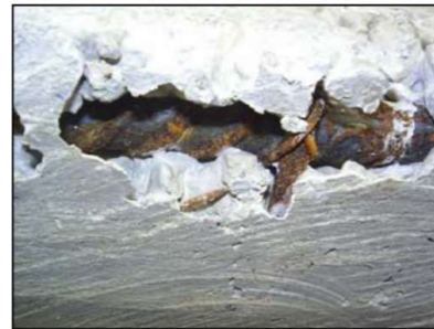
Fig. 28 Acero de refuerzo corroído
