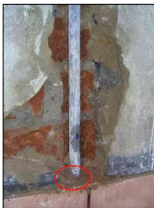
Fig. 40 Fuga de agua en tubería rota
