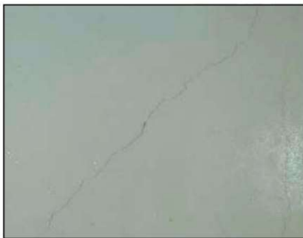
Fig. 05 Grieta de falla por corte
