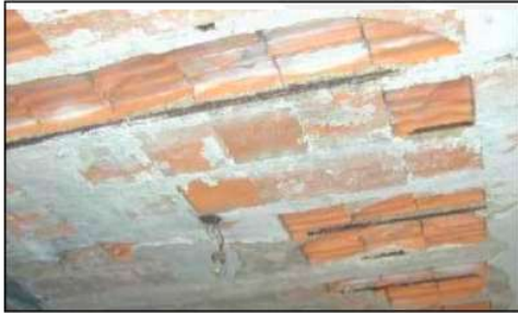
Fig. 25 Acero corroído de aligerado (Flores 2002)
