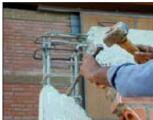
Fig. 46 Picado del nudo viga columna
