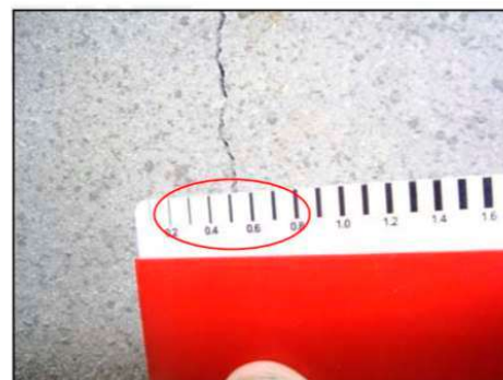
Fig. 06 Espesor de la grieta
