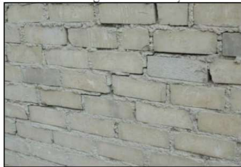
Fig. 14 Grieta de espesor mayor 1.5 mm. (Flores 2002)
