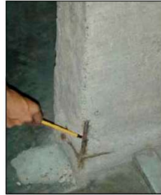
Fig. 26 Acero corroído de columna (Flores 2002)
