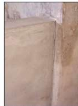
Grieta en unión tabique muro
