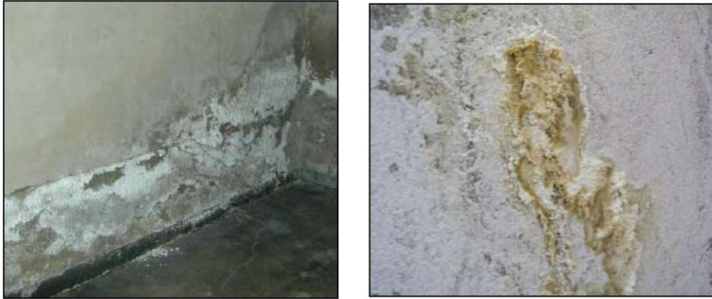
Fig. 34 Eflorescencia en muro
