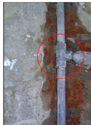
Fig. 41 Fuga de agua en la unión de tuberías
