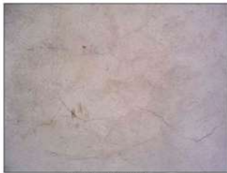
Grieta en tarrajeo
