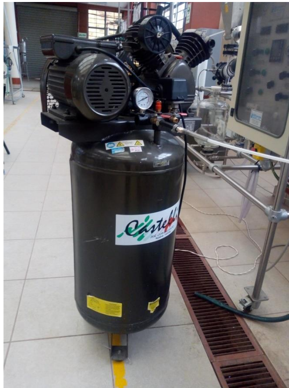
Figura B. 3. Compresor de aire FIQ-LOPU
