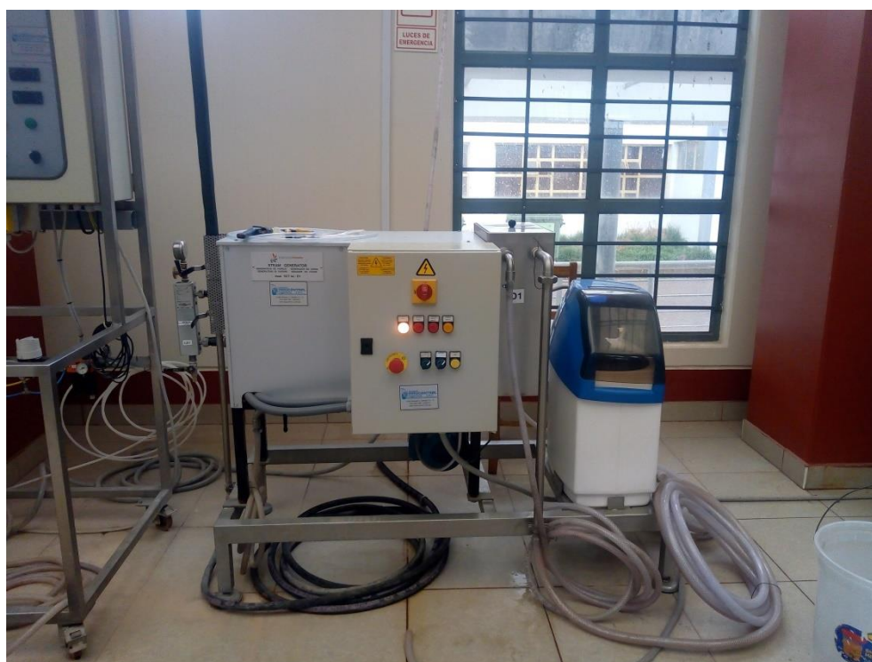
Figura B. 2. Generador de vapor de agua FIQ-LOPU
