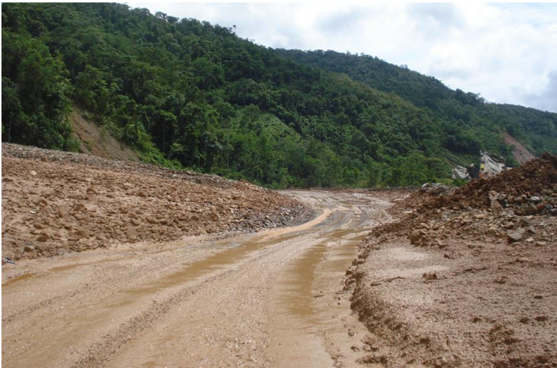
Vista hacía el margen derecha de la quebrada, acumulación de material aguas arriba y la formación de una banqueta que deberá ser eliminada aguas abajo.
